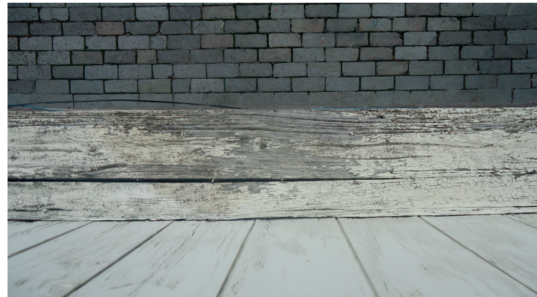
Fig 201: Desprendimiento de pintura
