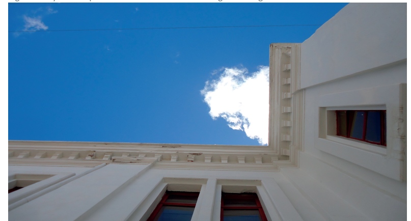
Fig 205: Desprendimiento de cornisa
