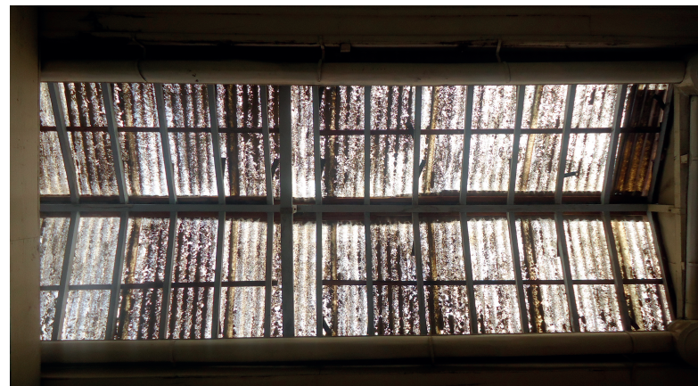
Fig 202: Presencia de suciedad en cubierta
