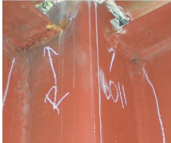
Figura 37. Juntas a penetración completa de mala calidad
