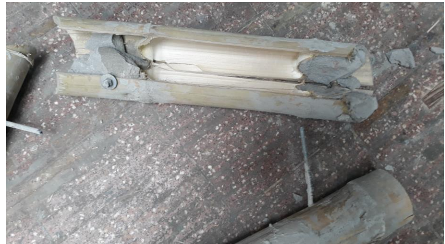
Imagen 3.35: Fractura longitudinal del cordón superior. Fuente: Cabrera, César. Archivo personal.
