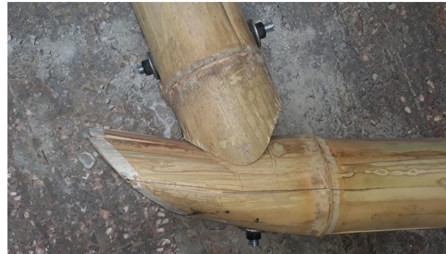
Imagen 3.28: Desplazamiento de la junta en la unión superior. Fuente: Cabrera, César. Archivo personal.
