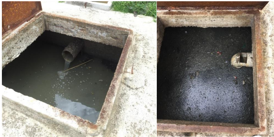
Gráfico 6.2. Comparación entre el agua residual antes y después de la modificación en la tubería de entrada de caudal.
