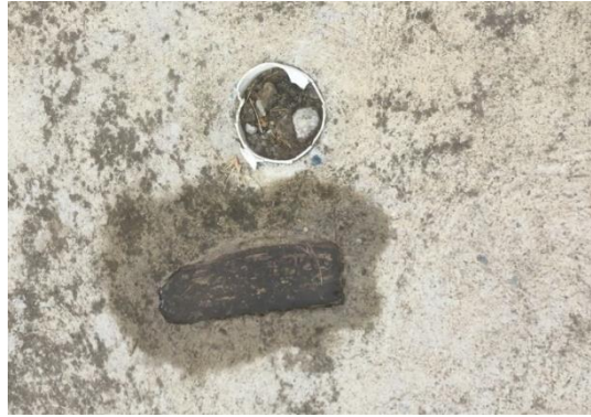
Gráfico 5.12. Ductos de ventilación taponados.
