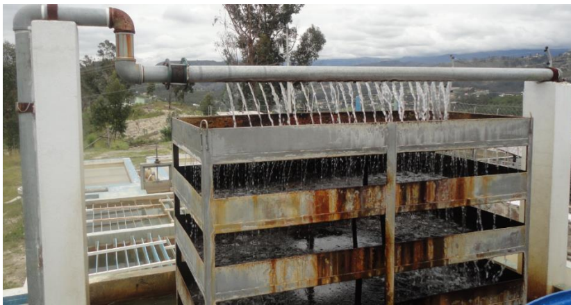
Figura 3.3 Tubo de conducción de agua cruda. Fuente el Autor
