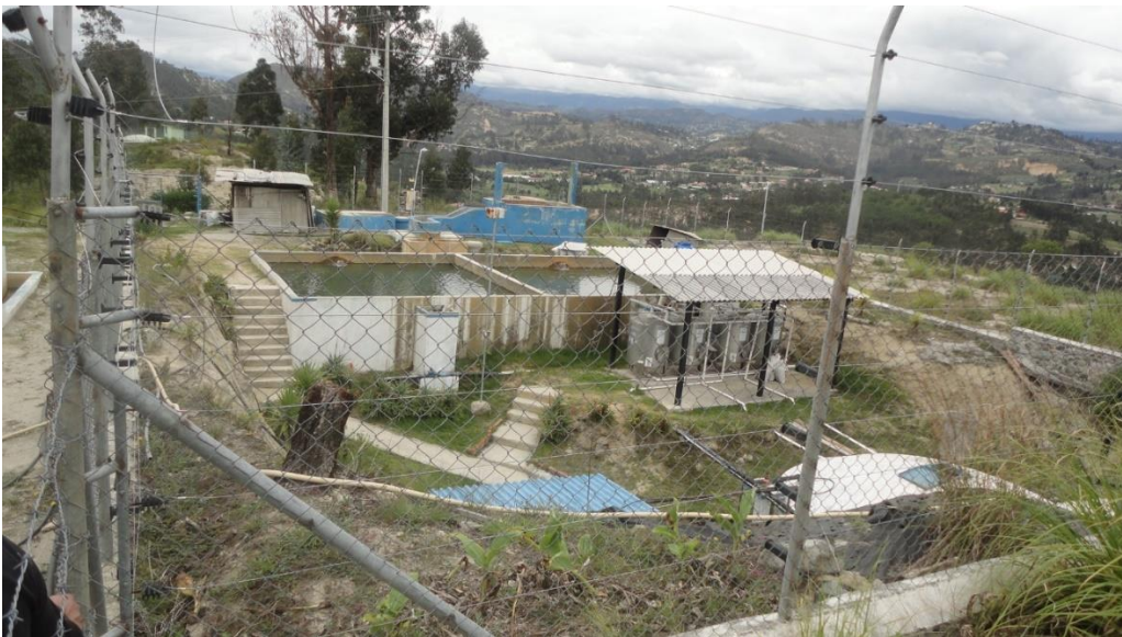
Figura 1.1 Planta de Tratamiento de Agua de San Cristóbal. Fuente el Autor
