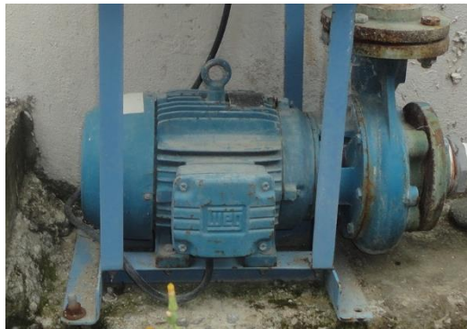
Figura 3.10 Bomba centrífuga mono bloque marca Pedrollo utilizada para bombear el agua disponible en el reservorio de 1000 litros. Fuente el Autor
