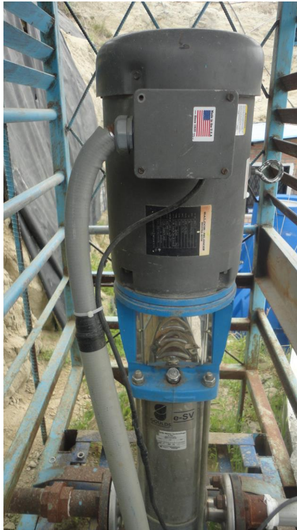
Figura 3.45 Bomba GOULDS trifásica, 220 VAC, 25 HP. Fuente el Autor
