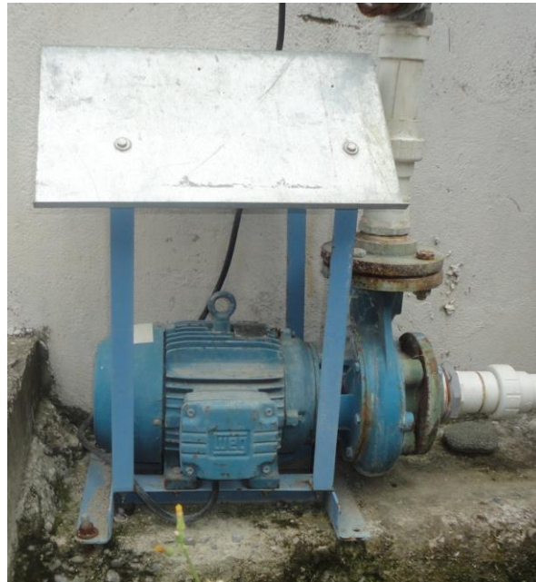
Figura 3.44 Bomba horizontal Pedrollo, 220 VAC, 7.5 HP. Fuente el Autor
