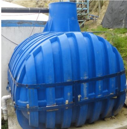
Figura 3.9 Reservorio de 1000 litros (tanque D). Fuente el Autor
