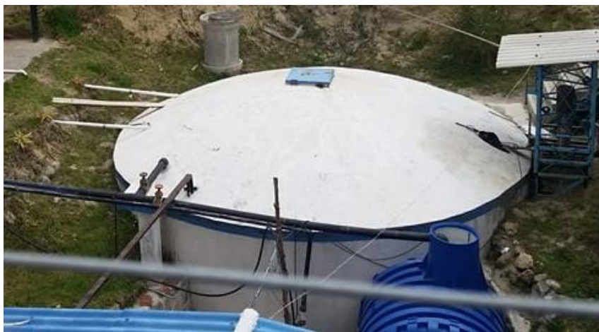
Figura 3.12 Reservorio de agua potable (tanque I). Fuente el Autor
