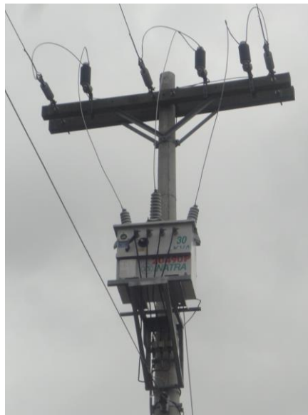
Figura 3.13 Transformador trifásico de 30 KVA. Fuente el Autor
