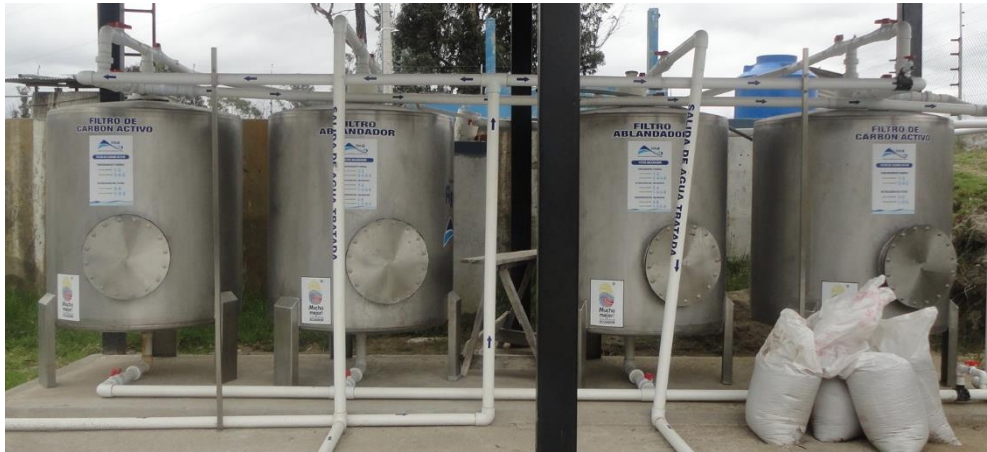
Figura 3.11 Filtros ablandadores y filtros de carbón activo (tanque E, F, G, H). Fuente el Autor
