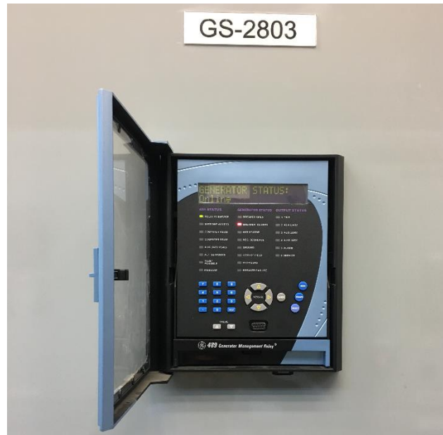
Figura 2.4.- Relé de protección General Electric 489.
