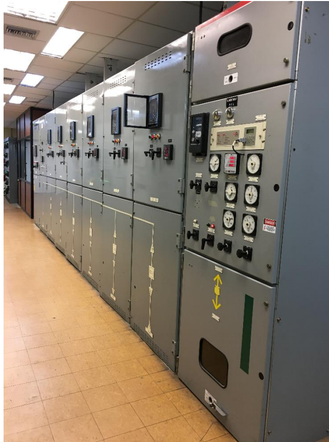
Figura 3.8.- Barra X-801, 4.16 kV.
