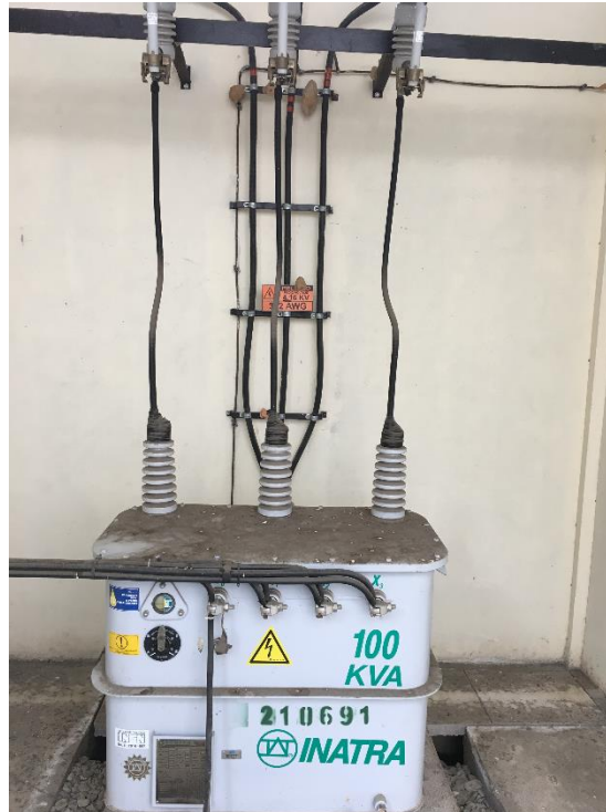
Figura 3.12.- Transformador de distribución X-003, Edificio de Contratos Fuente: Refinería Shushufindi.
