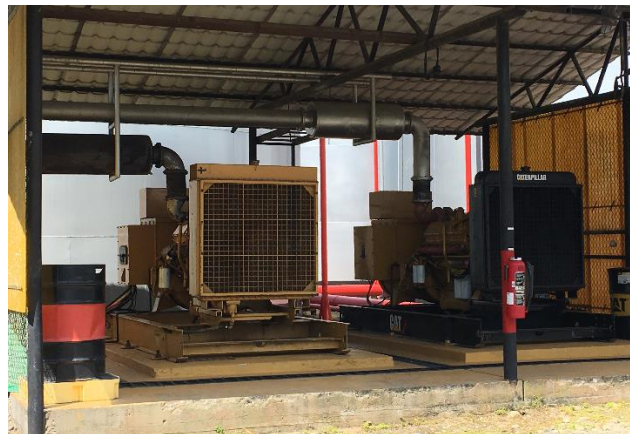
Figura 3.6.- Grupos Electrógenos GE2805 y GE2806.
