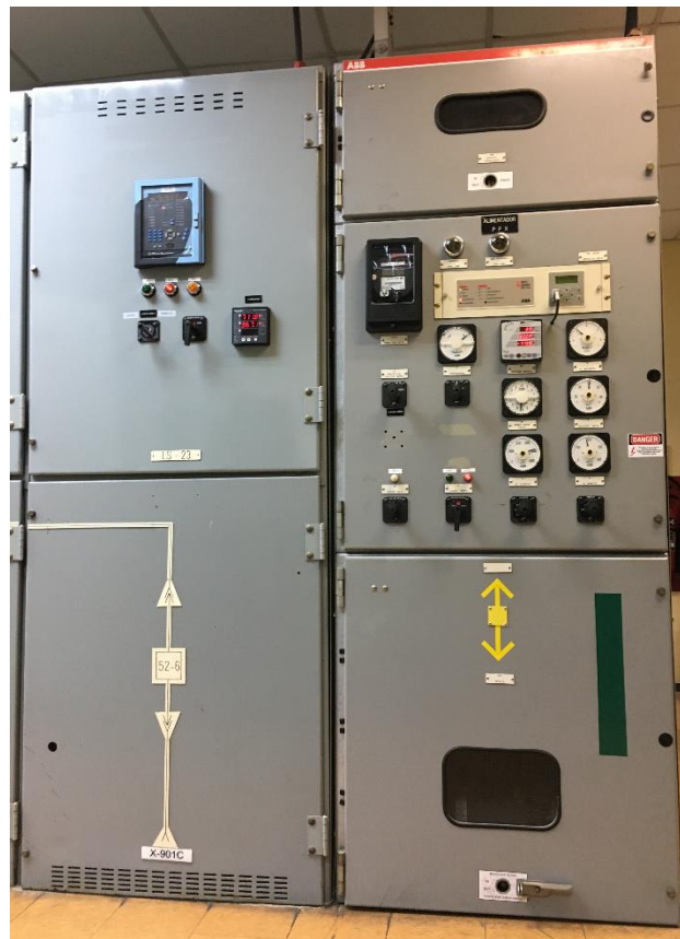
Figura 3.11.- Interruptores y relés de protección asociados: LS-23 y LS-PPR
