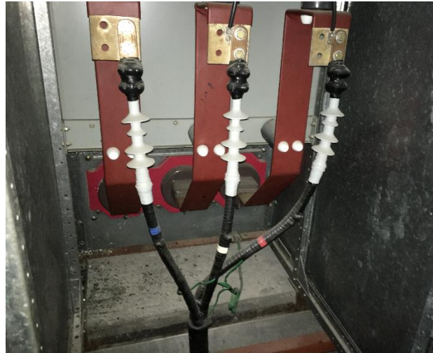
Figura 3.9.- Línea L-25, 4,16 kV.
