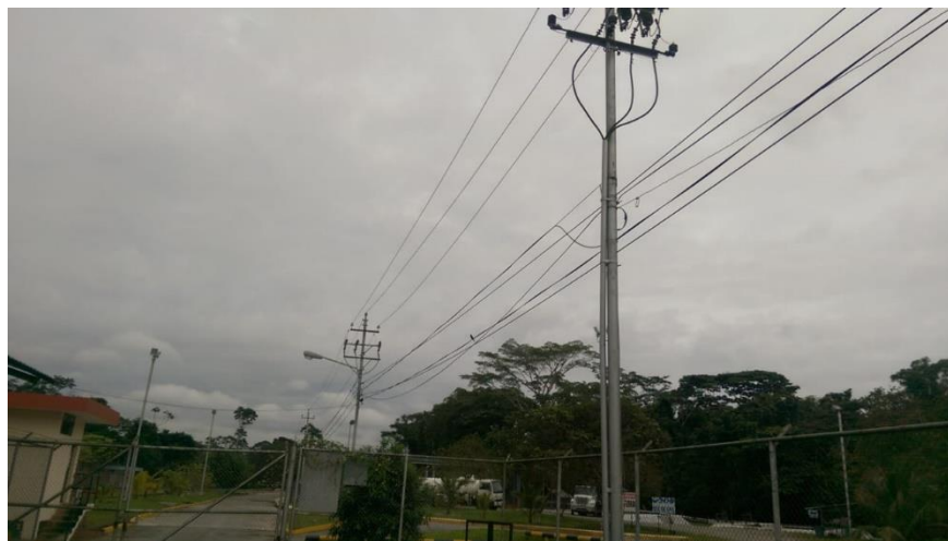
Figura 3.10.- Línea L-36 de distribución de medio voltaje.
