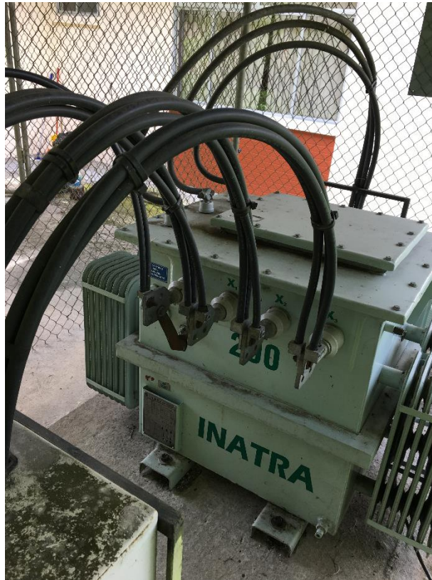
Figura 3.16.- Transformador de distribución X-904, Edificio de Seguridad, Salud y Ambiente.
