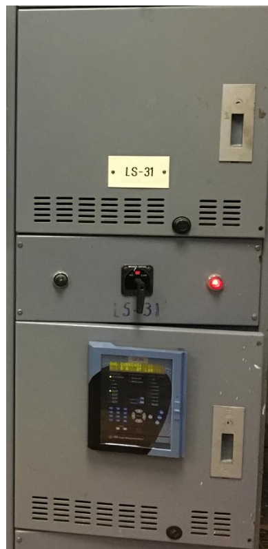
Figura 3.15.- Interruptor - Relé LS-31.
