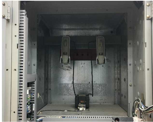
Figura 2.1.- Transformador de Potencial (TP).
