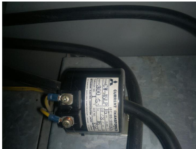
Figura 2.2.- Transformador de Corriente (TC).
