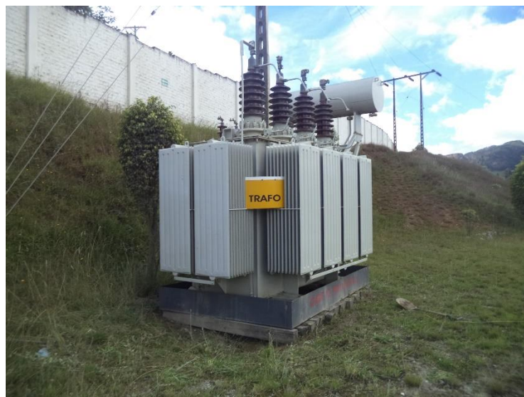
Figura 3.2. Transformador trifásico con enfriamiento en aceite.
