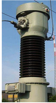
Figura 3.4. Transformador de corriente.
