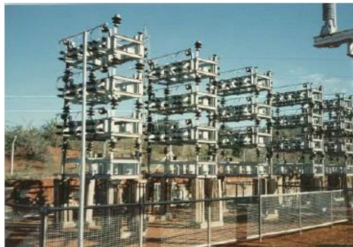
Figura 3.6. Banco de capacitores en paralelo.
