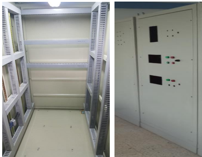
Figura 4.19. Tableros para las borneras y equipos de protección.
