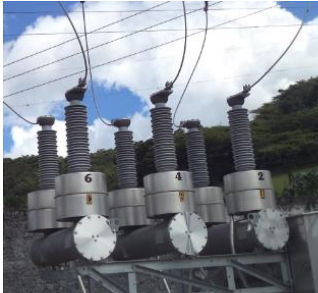
Figura 4.15. Interruptor tanque muerto para 69kV.
