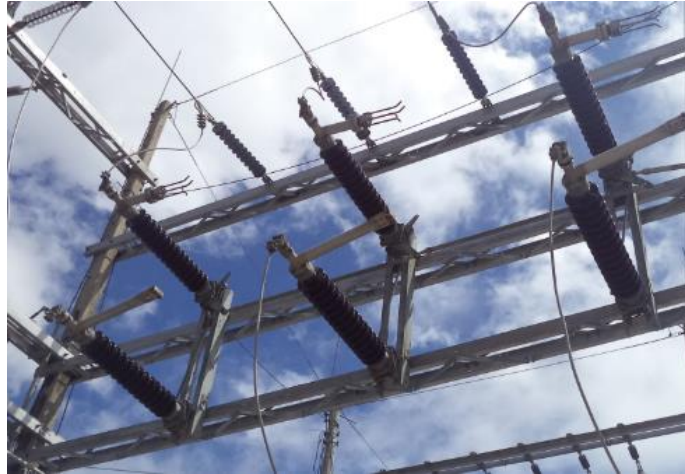
Figura 4.8. Seccionador tripolar de barra con mando mecánico.
