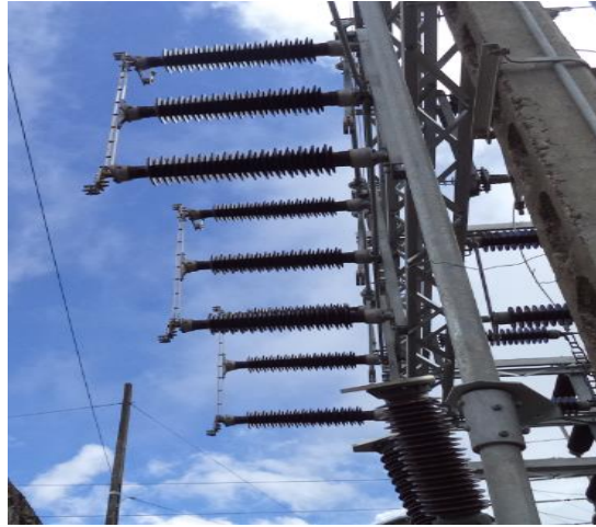
Figura 4.12. Seccionador tripolar con puesta a tierra y mando eléctrico.
