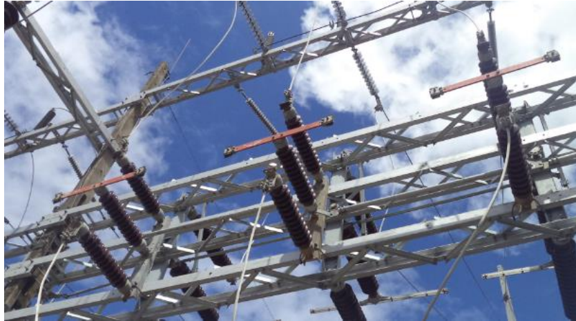
Figura 4.14. Seccionadores tripolar con mando mecánico.
