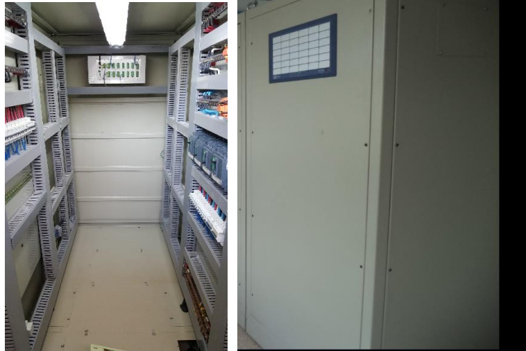
Figura 4.16. Tablero de servicios auxiliares y alarmas.
