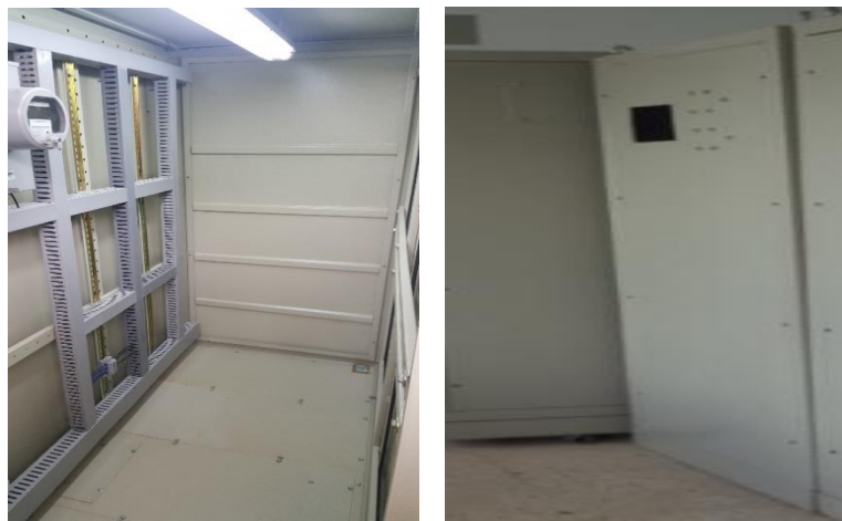
Figura 4.20. Tablero para la bahía del transformador.
