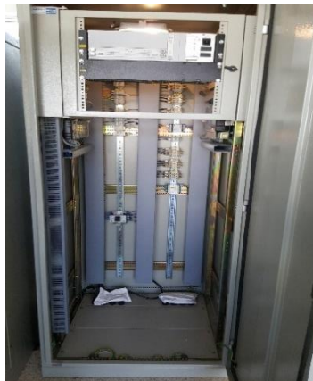
Figura 4.21. Tablero de la RTU.
