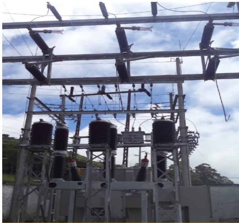
Figura 4.5. Bahía del transformador de Potencia.
