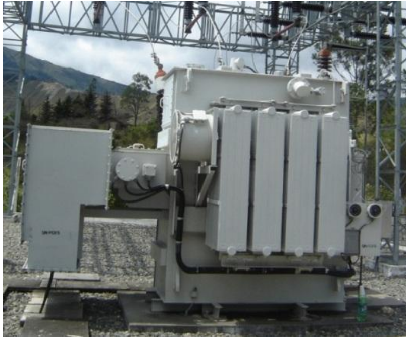
Figura 4.6. Transformador de potencia de 2.5MVA de la S/E Velacruz.
