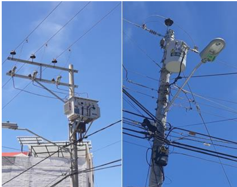
Figura 2.10 Transformador monofásico y trifásico Fuente: CNEL EP Bolívar
