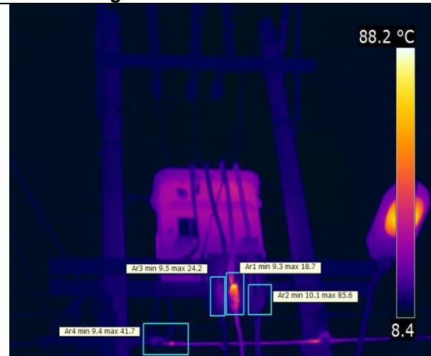
Imagen TERMOGRAFIA INFRARROJA
