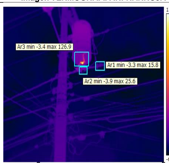
Imagen TERMOGRAFIA INFRARROJA
