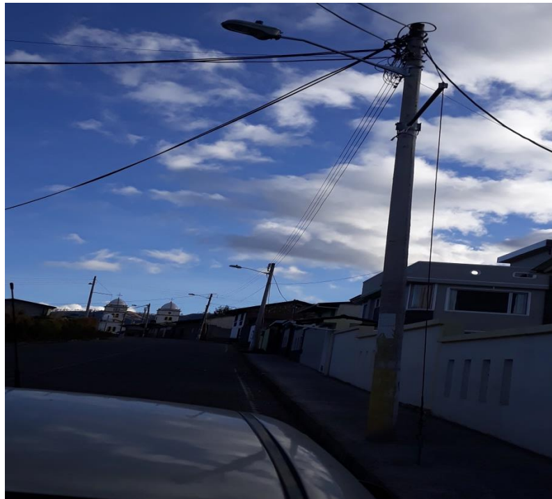
Figura 2.21 Red de BV con Conductor de Al tipo ACSR Fuente: CNEL EP Bolívar.
