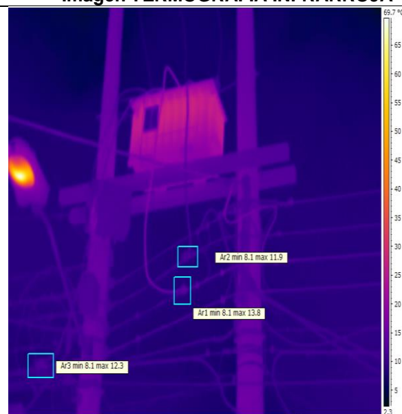
Imagen TERMOGRAFIA INFRARROJA
