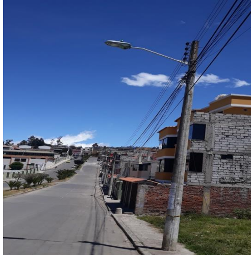
Figura 2.18 Red de distribución secundaria Fuente: CNEL EP Bolívar
