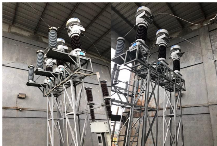
FIGURA 5.7: Transformador de Medida
