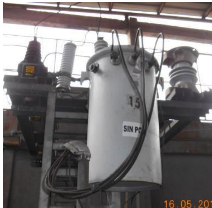
FIGURA 1.31: Transformador servicios auxiliares Subestación Santo Domingo
