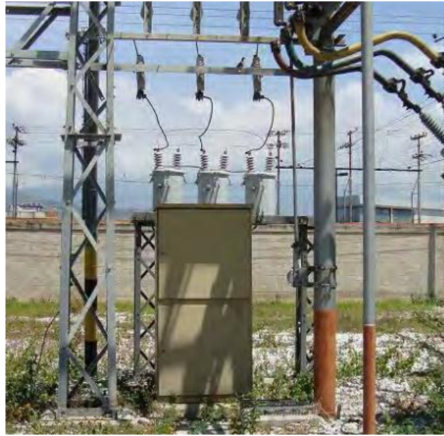
FIGURA 1.30: Banco de transformadores de servicios auxiliares. (Martinez, 2012)
