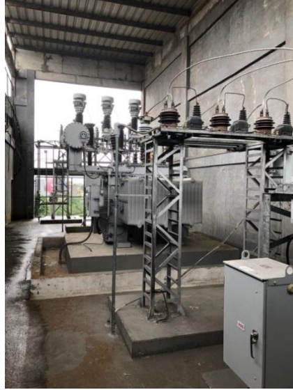
FIGURA 5.4: Subestación de transformación
