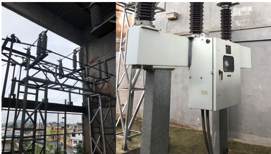
FIGURA 5.9: Barras y tableros
