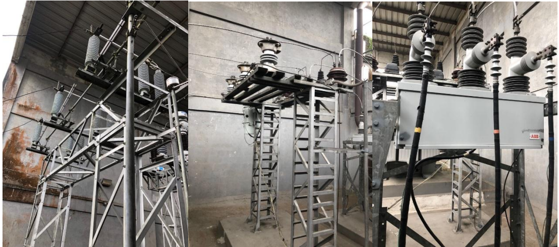
FIGURA 5.8: Elementos de maniobra y protección
