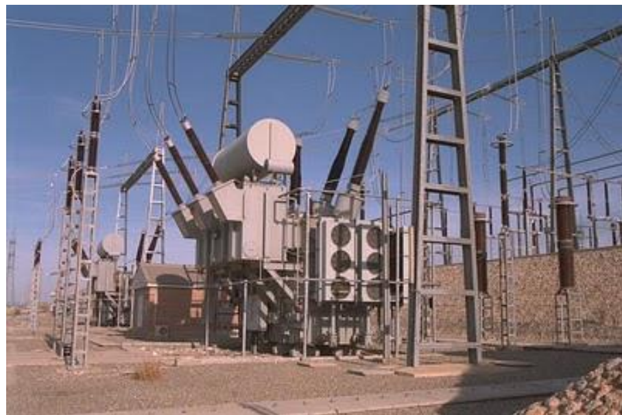
FIGURA 1.25: Pararrayos Autoválvula, usado en la protección de un autotransformador. Se ubica en la parte izquierda de la imagen. (Vasalles, 2010)
