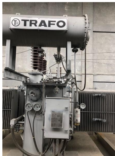
FIGURA 5.5: Transformador de Potencia
