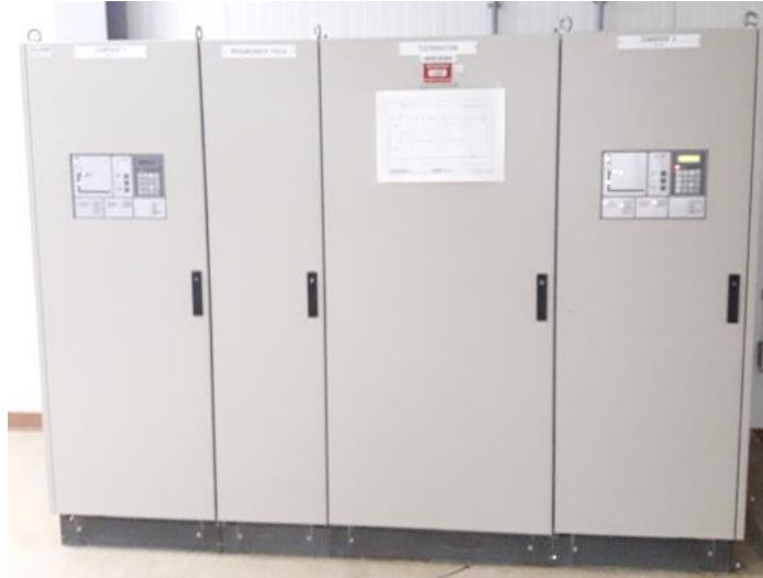
FIGURA 1.34: Sistema redundante para carga de baterías de sistema de control GUTOR. SPF OSOB
