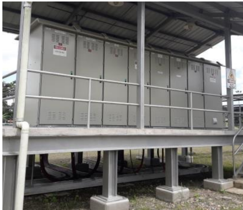
FIGURA 1.32: VFI tablero de llegada de estación OSOI 13.8 kV
