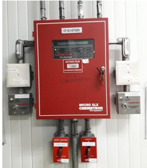
FIGURA 1.36: Tablero de sistema contra incendio cuarto de control SPF OSOB
