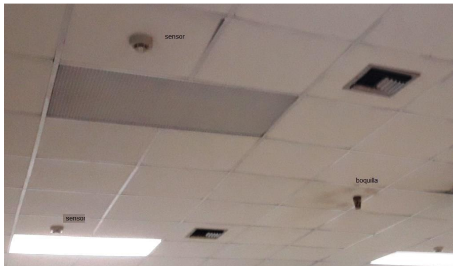
FIGURA 1.37: Sensores y boquilla de sistema contra incendio Cuarto de control SPF OSOB
