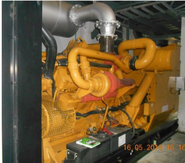
FIGURA 1.35: Generador auxiliar, Subestación Santo Domingo
