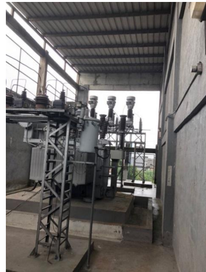
FIGURA 5.3: Subestación de transformación
