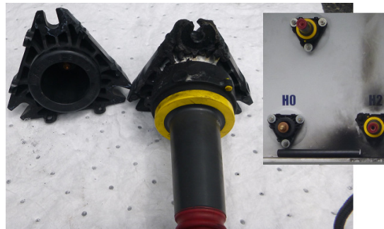
Figura 6.22 Terminal dañado en transformador. Fuente: Elaboración propia.
