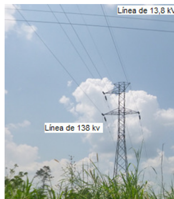
Figura 6.23 Líneas de 138 kV y 13,8 kV en las cercanías de Loreto. Fuente: Elaboración propia.
