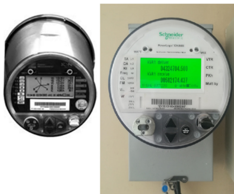
Figura 5.1 Medidor ION PowerLogic 8650. Fuente: [18] Elaboración propia.
