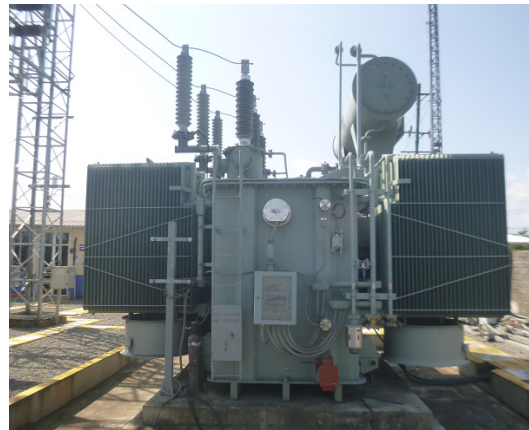
Figura 4.5 Transformador Subestación Payamino 69/13,8 kV. Fuente: Elaboración propia.
