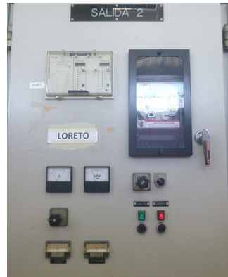
Figura 4.8 Tablero de control del alimentador Loreto. Fuente: Elaboración propia.
