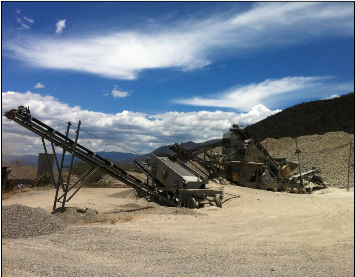
Figura 4.3. Planta Trituradora 1. (Fuente autores)
