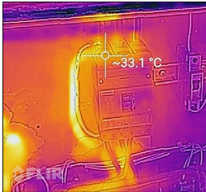
Figura 2.23. Foto térmica cuantificada. (Fuente autores)
