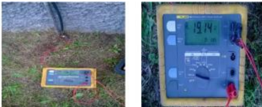
Figura 53. Resistividad del Pararrayos T-3. (Anexo 1)
