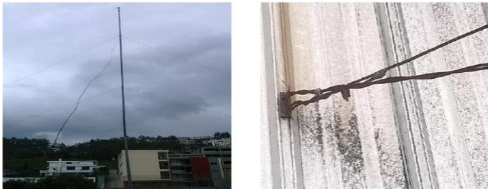
Figura 55. Pararrayos y tensores. (Anexo 2)
