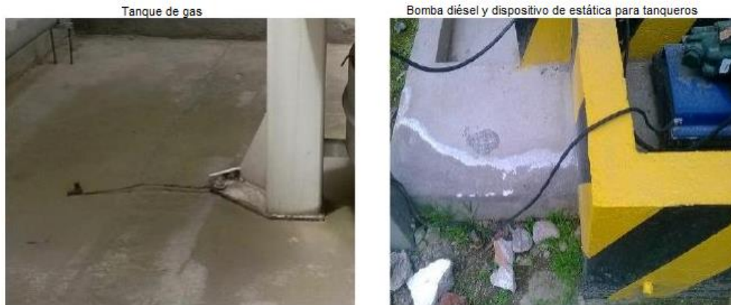
Figura 56. Conectados a varillas Copperweld independientes. (Anexo 2)
