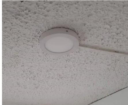
Imagen 36. Nuevo sistema de iluminación de la guardería C. Cuarta visita
