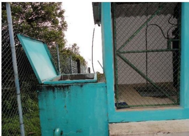
Figura 4. 23 Tanque de cloración.
