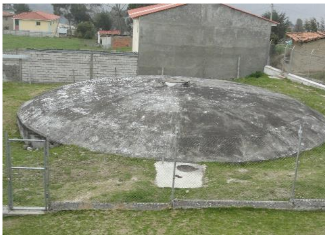
Figura 4. 4 Tanque de almacenamiento de 600 m 3 de capacidad.
