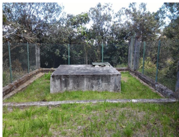
Figura 4. 22 Tanque de carga captación 2 (GAD Suscal, 2015).
