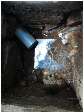
Figura 4. 21 Captación 2 (GAD Suscal, 2015).
