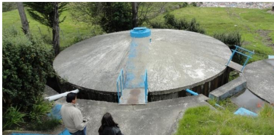
Figura 4. 18 Tanque de almacenamiento de 300 m 3 de capacidad.
