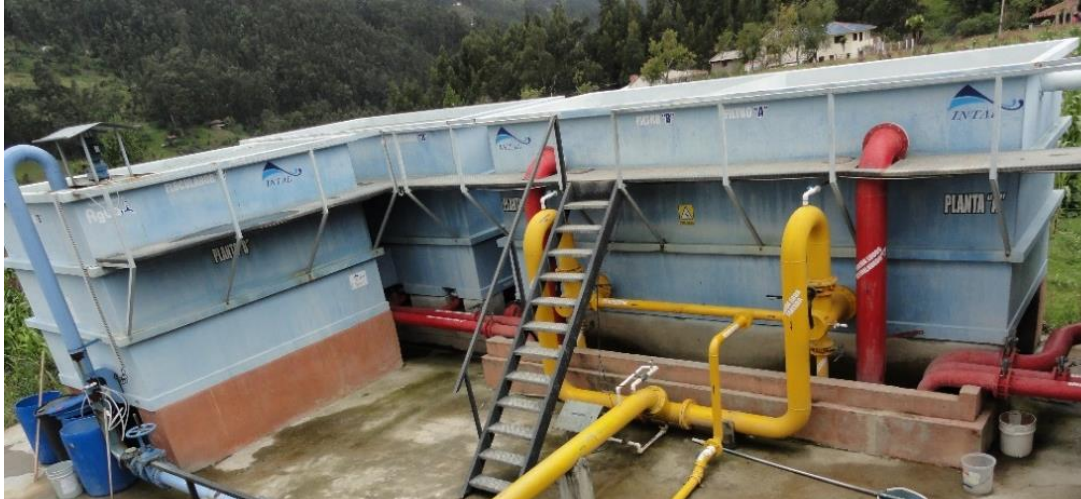
Figura 4. 9 Módulo A, planta de tratamiento compacta.
