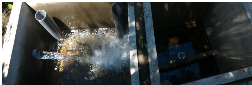
Figura 4. 20 Tanque de carga de la captación 1 (GAD Suscal, 2015).
