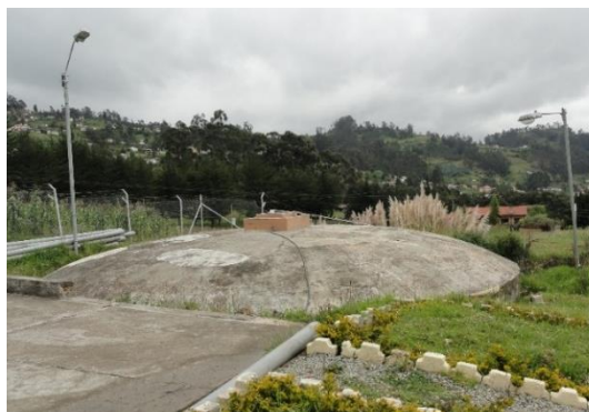
Figura 4. 11 Tanque de almacenamiento de 277 m 3 de capacidad.
