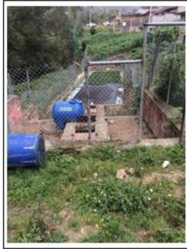
Figura 13. Planta de tratamiento agua residual.
