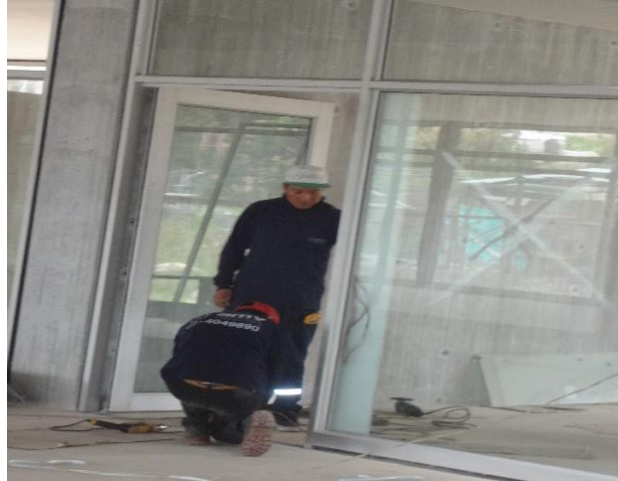
Ilustración 25. Puertas de aluminio y doble vidrio (cámara)
