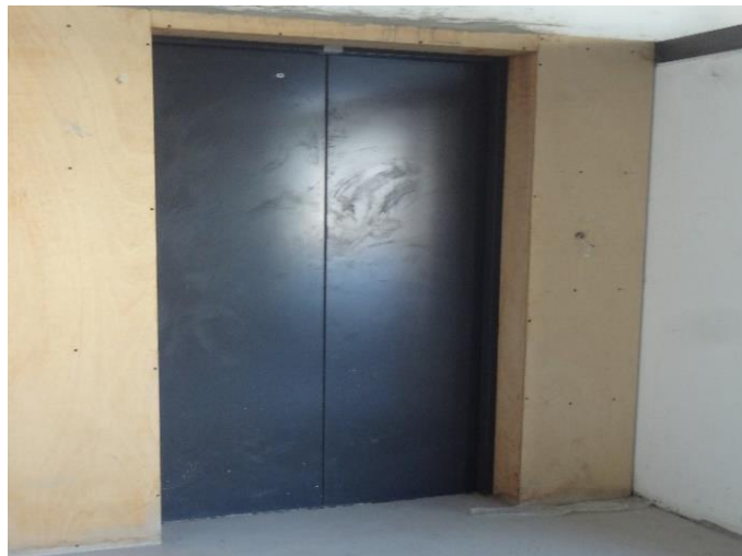
Ilustración 33. Ascensor capacidad 630 Kg (8 personas) de acuerdo a la Especificación
