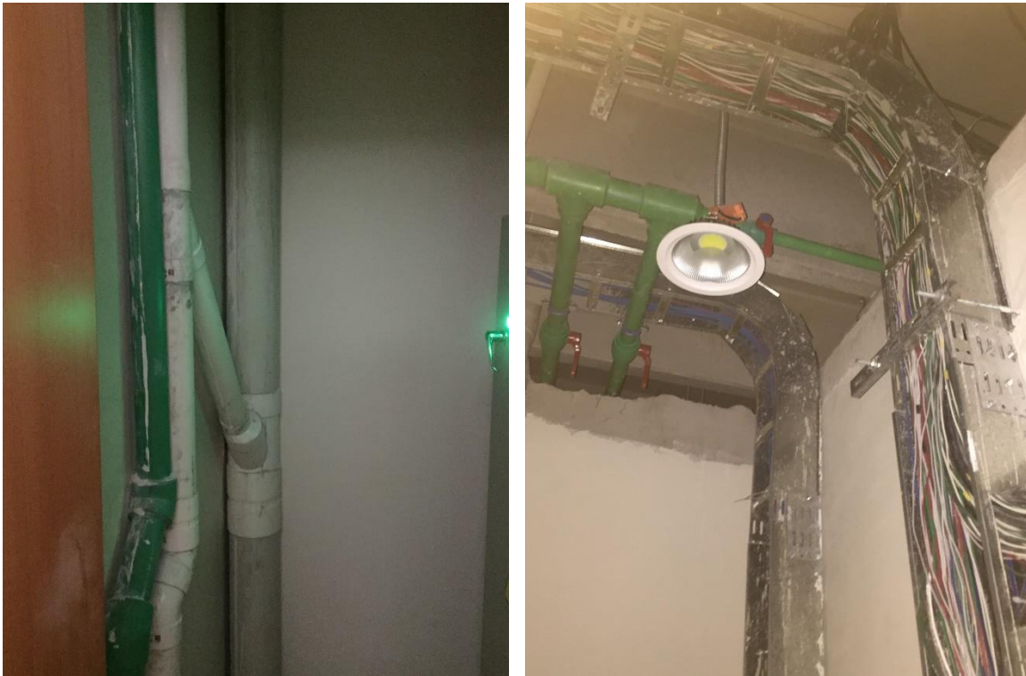
Ilustración 69. Cuarto de ductos, tubos PVC y cables
