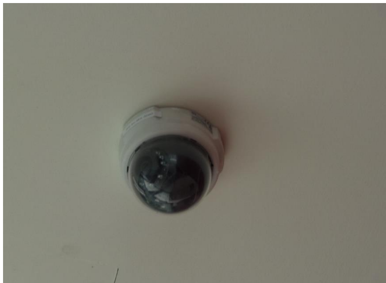
Ilustración 50. Cámara de seguridad usada en interiores
