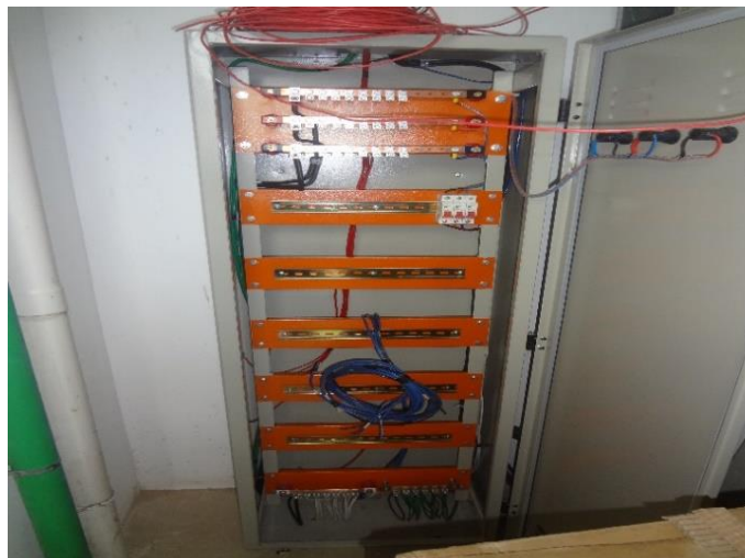
Ilustración 37. Tablero de Control Completo con 16 relojes Digital, Relés y Protecciones.
