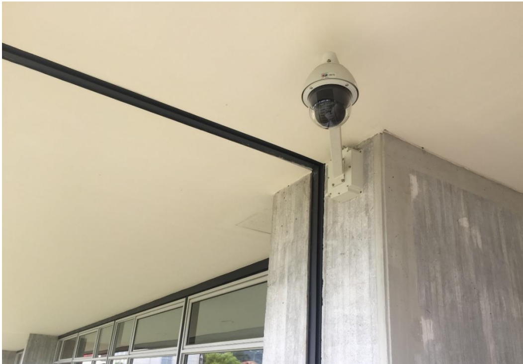
Ilustración 51. Cámara de seguridad, usada en exteriores (Planta baja)
