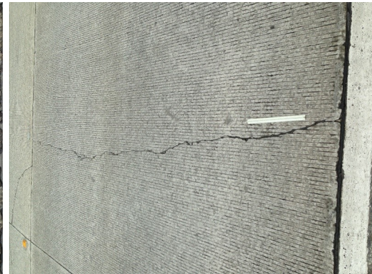
(d) Grieta lineal (Transversal)
