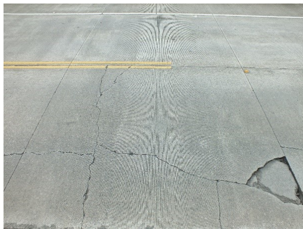
(e) Losa dividida. Severidad Media.
