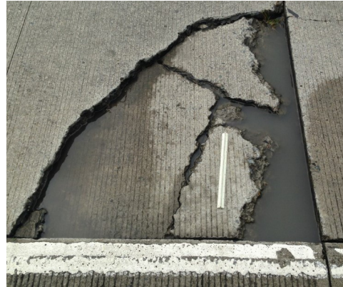
(b) Grieta de esquina. Severidad Alta
