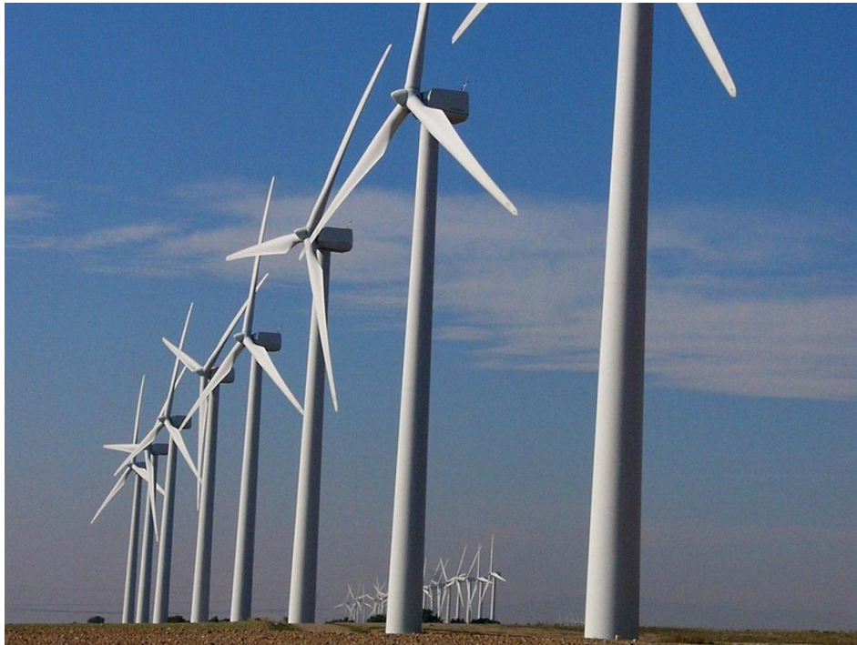
Figura 1.21: Aerogeneradores sobre torres tubulares
