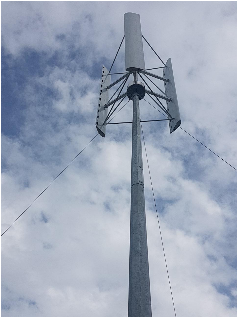
Figura 3.7: Aerogenerador de eje vertical TYD-WT-5000 en la granja Irquis
