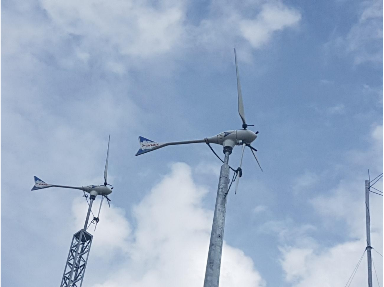
Figura 3.4: Turbina eólica ENAIR 70 PRO ubicada en la granja Irquis
