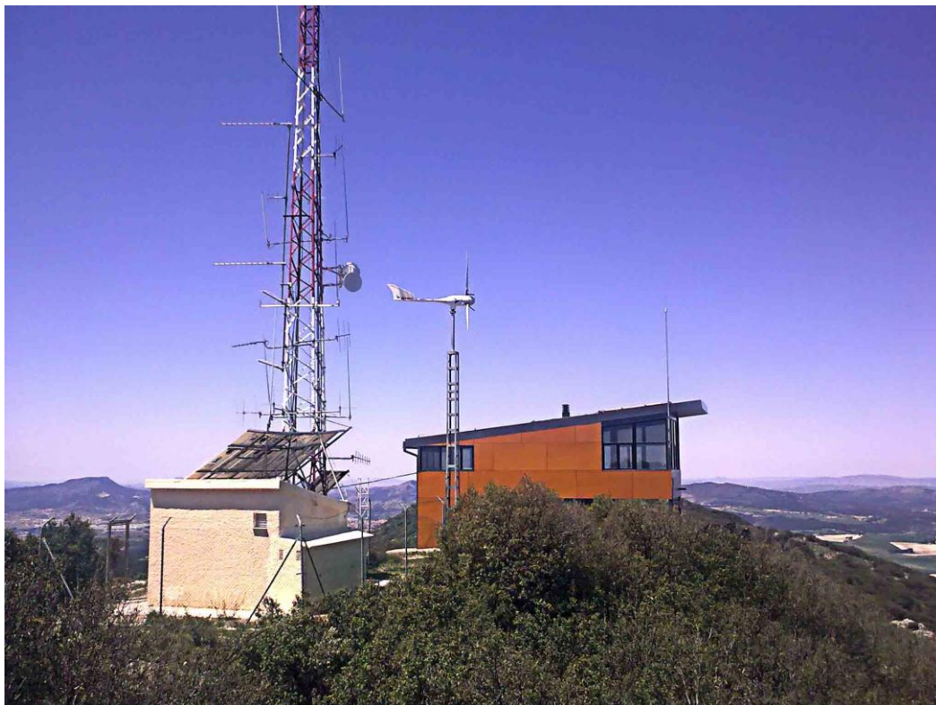
Figura 2.8: Aerogenerador para alimentación de antena de telefonía
