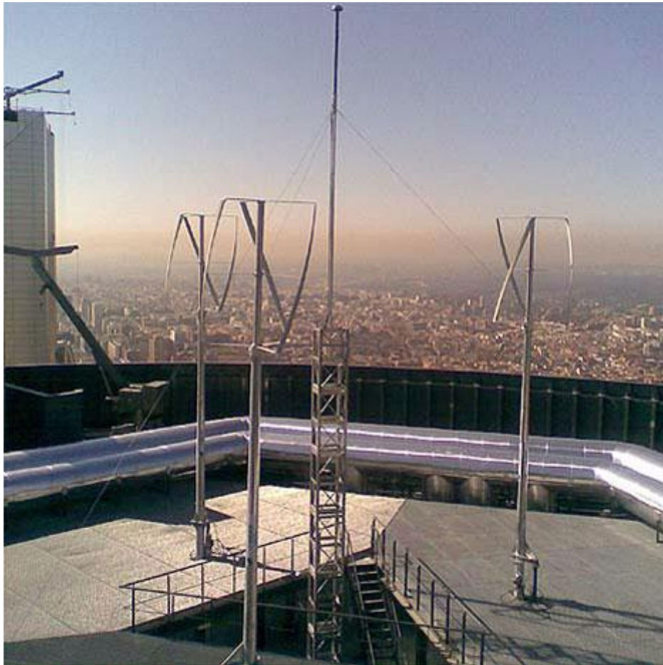
Figura 2.10: Instalación micro-parque eólico en la Torre Sacyr
