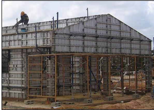
Imágen 5. Ejemplo del armado de una vivienda con formaletas de aluminio. Tomado de www.forsa.com.co
