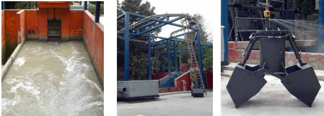
Figura 1. Cajón de llegada, By-pass y Compuerta de admisión; Sistema de rieles para la extracción automática de lodos.
