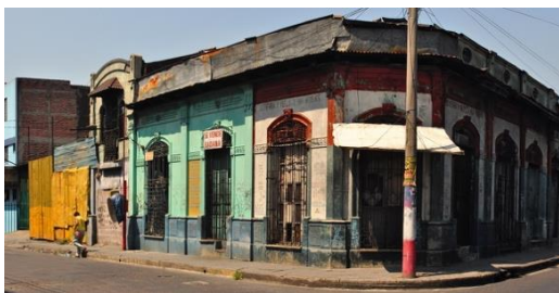
Figura 9: Casa deteriorada de lámina troquelada y madera en la Avenida Independencia (2010).
