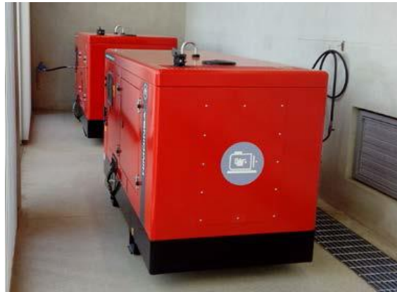
Figura 3.22 Generador de diésel y gas licuado de petróleo
