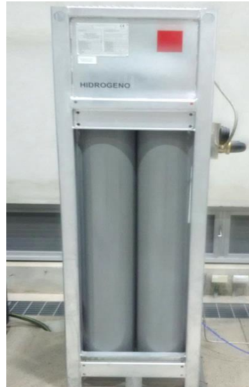
Figura 3.26 Celda de hidrogeno
