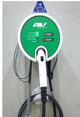
Figura 3.36 Estación de carga
