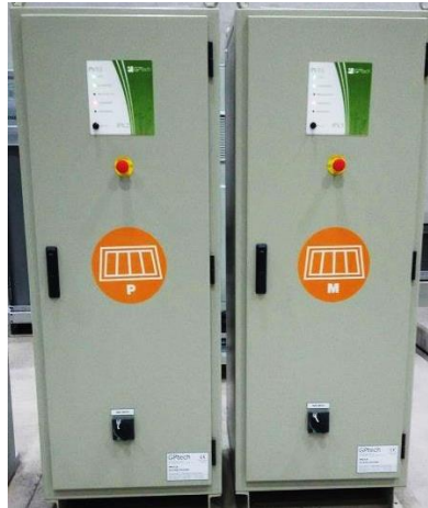
Figura 3.38 Inversores de los paneles fotovoltaicos
