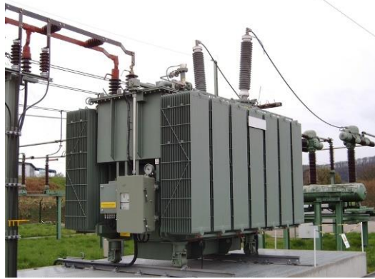
Figura 2.6.9 Transformador. (Fuente: http://jdelectricos.com.co/transformadores-electricos-abb-en-colombia/ ).
