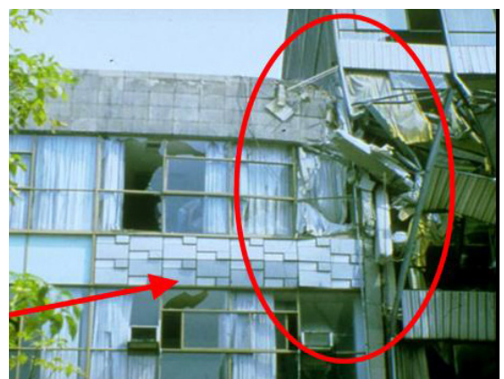
Figura 227: Las losas de entresijos de los edificios más bajos, golpean las columnas del edificio más alto y causa daños severos en este último.
