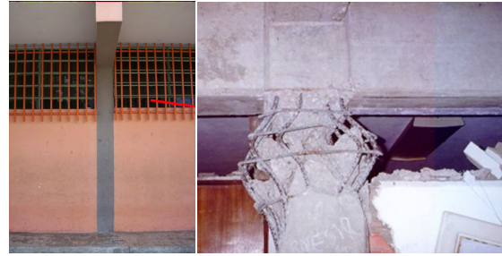
Figura 231: Falla típica de columna corta
