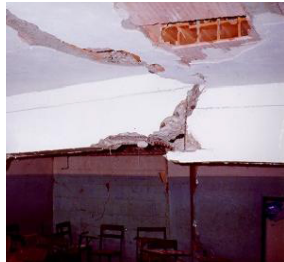
Figura 223: Falla por acción sísmica en columna
