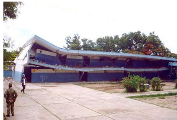
Figura 224: Daño causado por falta de rigidez lateral.
