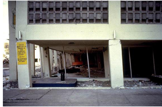
Figura 228: El daño estructural provocado por la planta débil, conllevó a la inutilización del edificio.
