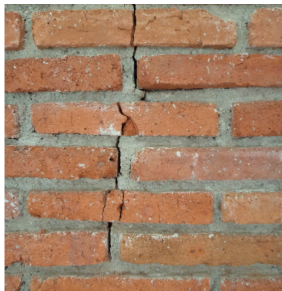
Figura 255: Grietas por falta de refuerzos metálicos.
