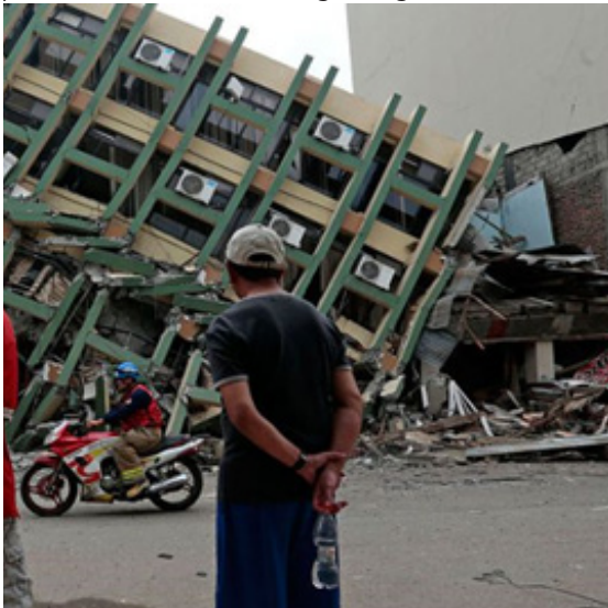
Figura 232: Edificio en ruinas en la ciudad Pedernales luego de ser impactados por un sismo.
