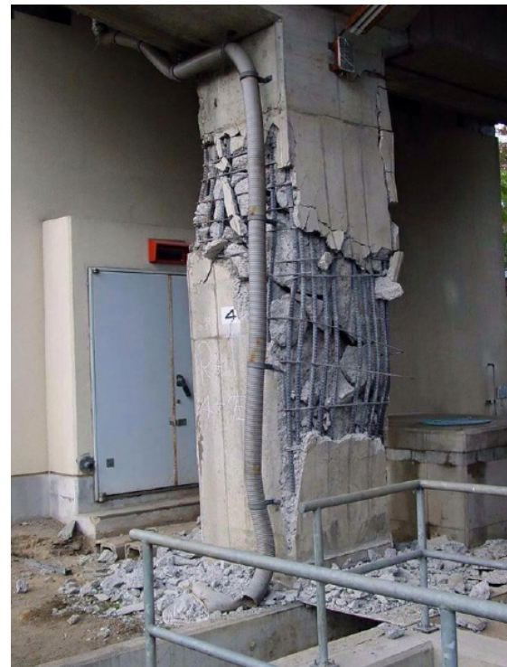
Figura 233: Fracaso de columnas ante fuerzas sísmicas.
