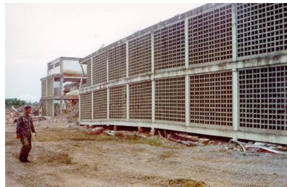
Figura 229: Colapso total de la planta baja del edificio
