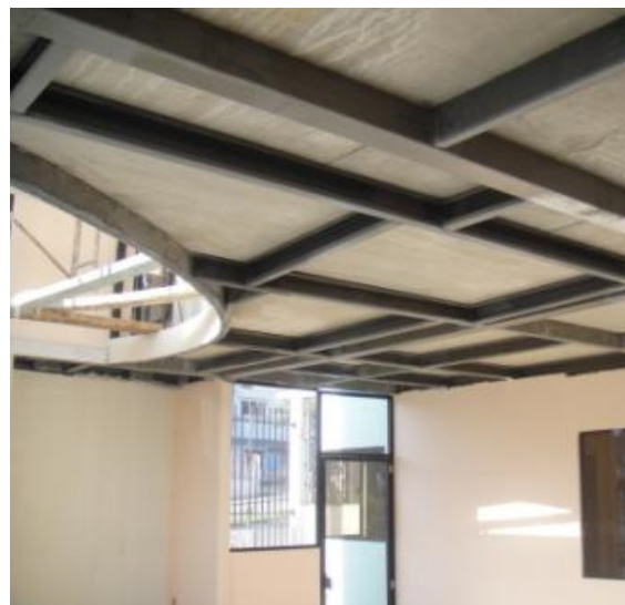
Figura 250: Ejemplo de colocación de correas metálicas en la parte inferior de losas de hormigón.
