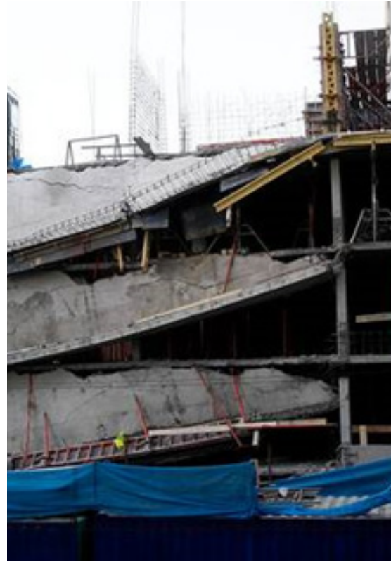
Figura 246: Losa colapsada por falla sísmica.
