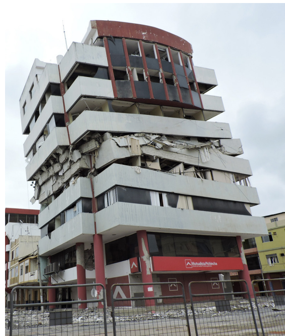
Figura 230: Colapso total de pisos superiores
