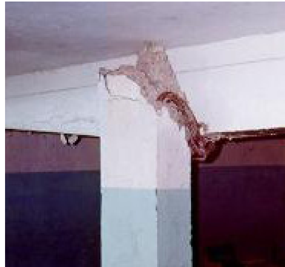
Figura 225: vigas desprendidas de las columnas.
