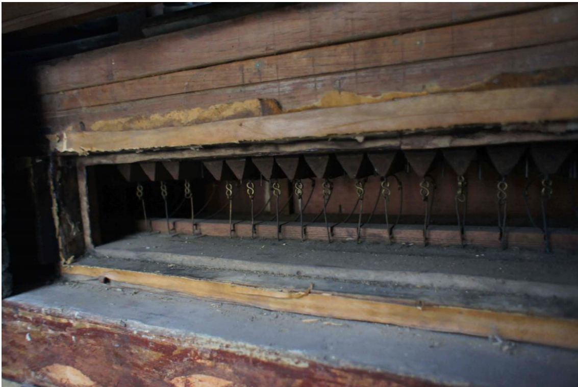
Imagen 10 - Vista frontal de las válvulas principales con sus tirajes a las reducciones (13-05-16)
