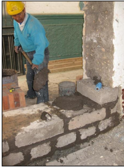
Fotografía 39. Construcción muro de adobe Restauración de la Ex Escuela Central Fuente: Autora
