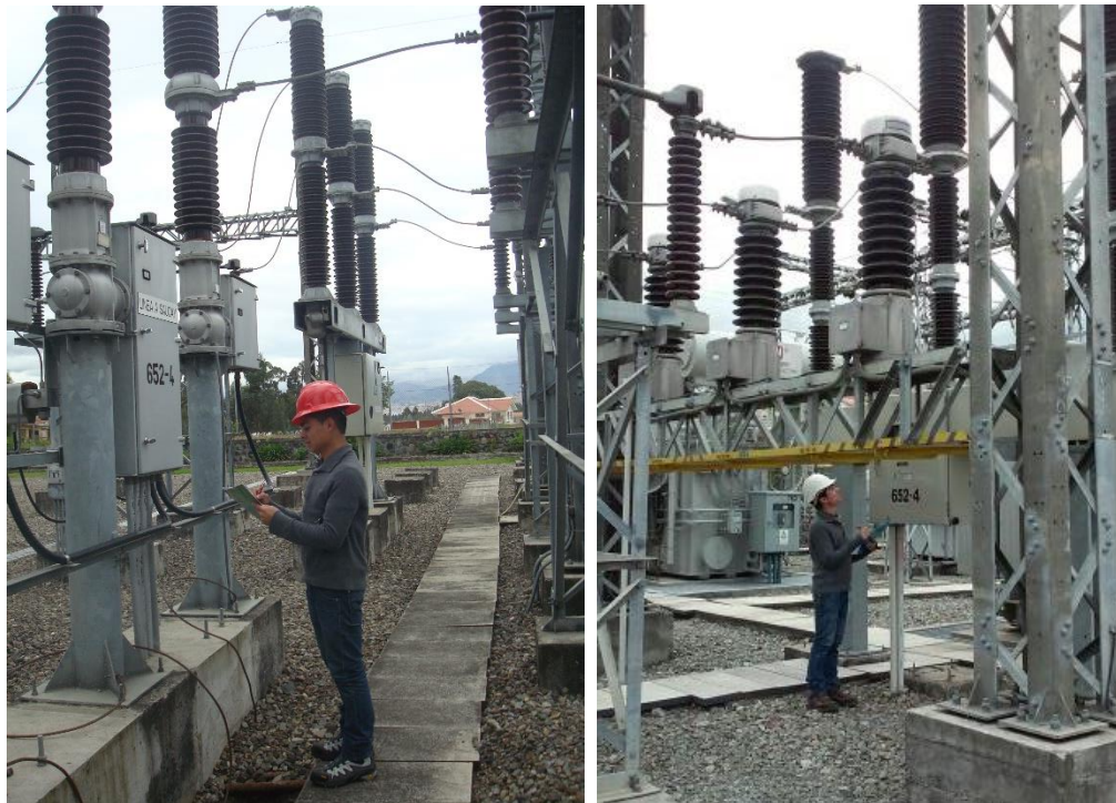
F8 y F9: Verificación de datos de disyuntores activos en las subestaciones "El Descanso" y "Monay", respectivamente. CENTROSUR. Fuente: Autor, 2017.
