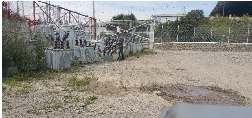
F5: Registro de equipos reconectores dados de baja. Visita técnica a la Bodega “El Descanso”, CENTROSUR. Fuente: Autor, 2016.
