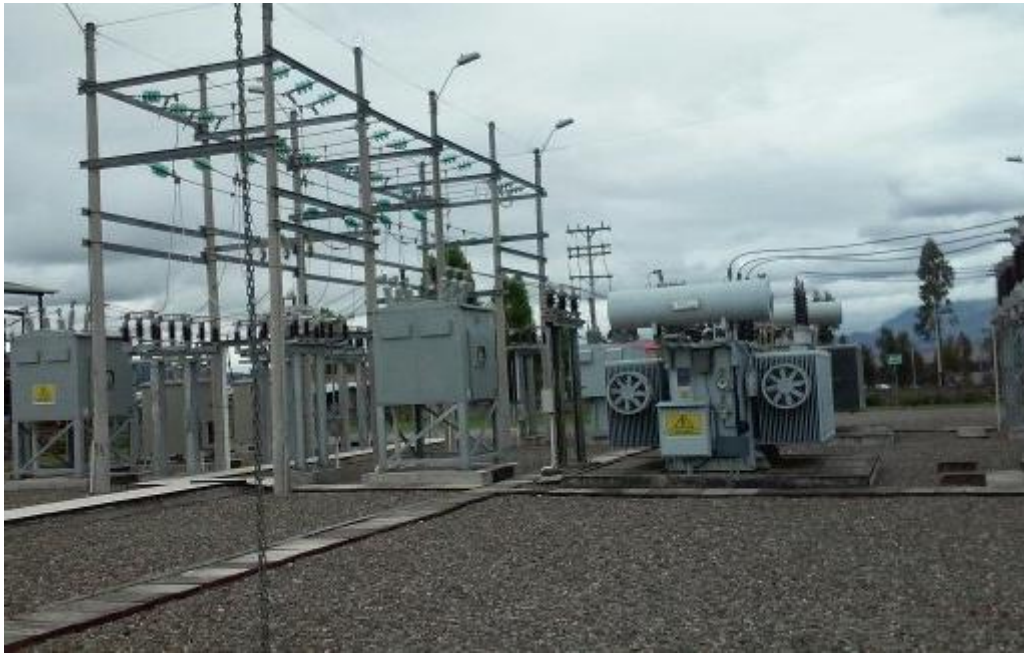
F7: Subestación N°14 "Ricaurte", CENTROSUR. Fuente: Autor, 2017.
