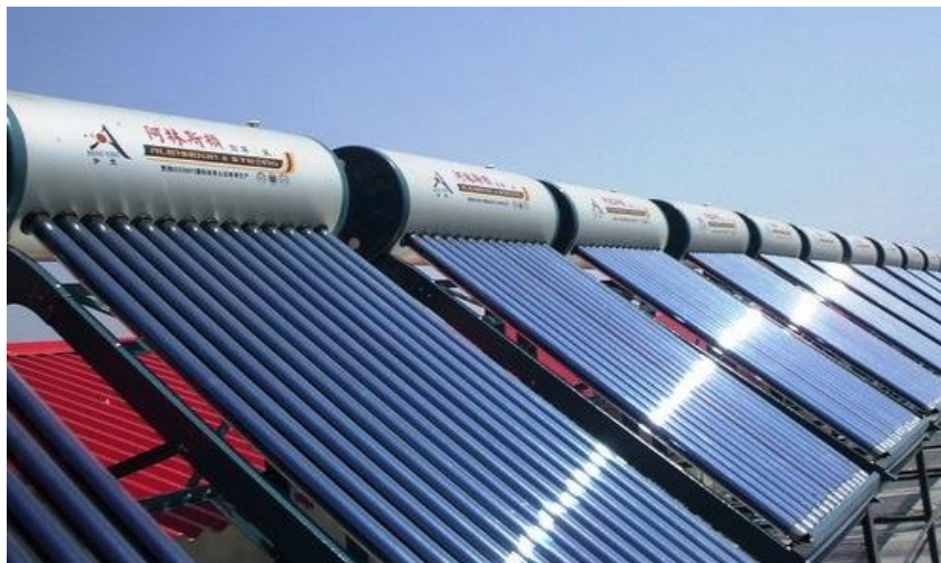
Figura 2.4 Sistema solar térmico
