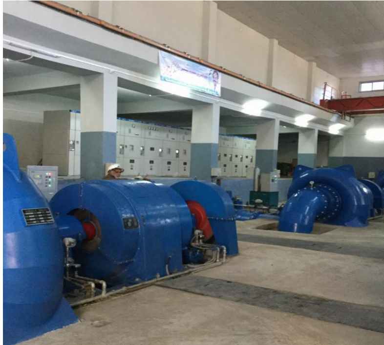
Figura 2.6 Mini central hidráulica
