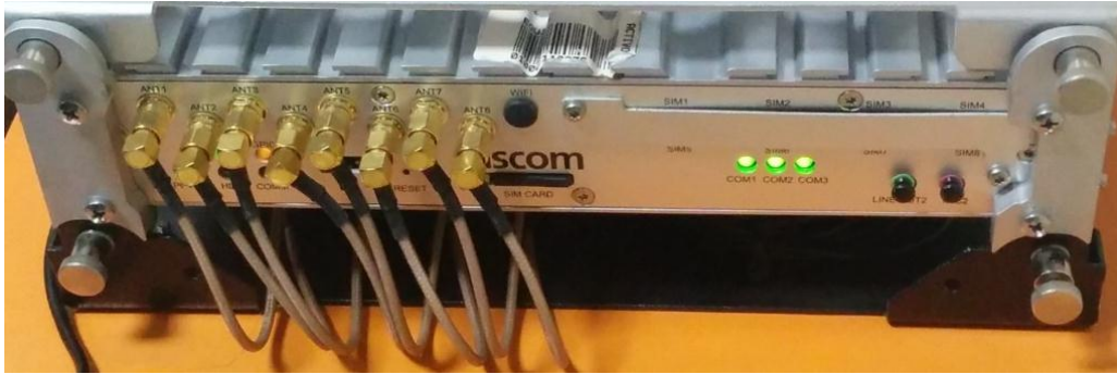
Figura 22. Subsistema de Mediciones, RTU con cuatro dispositivos internos [42].
