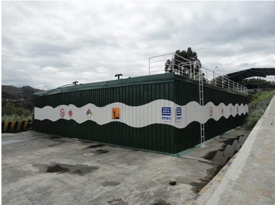
Imagen 2. Tanque de almacenamiento de aceites usados ubicado en la Planta de tratamiento de Aguas Residuales Ucuabamba, Cuenca. Fuente (ETAPA EP, 2017)
