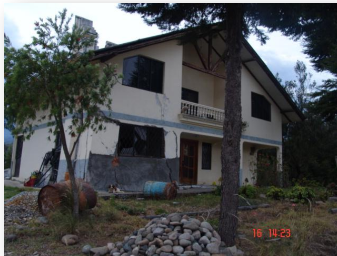
Fotografía 41: Deslizamiento en el sector de El Arenal Aguacolla año 2009
