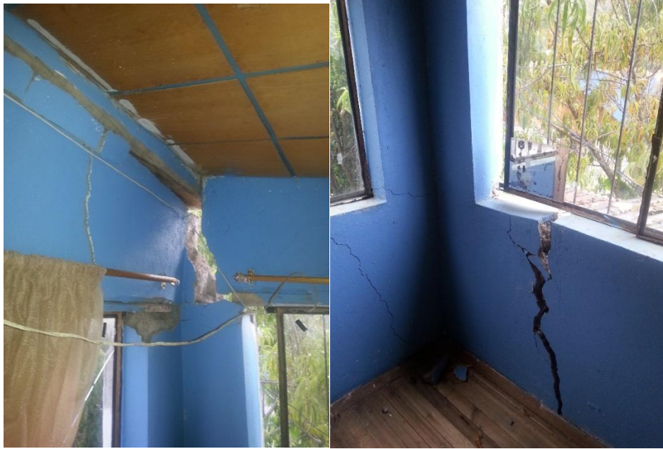
Fotografía 68: Casa Afectada por los Deslizamientos
