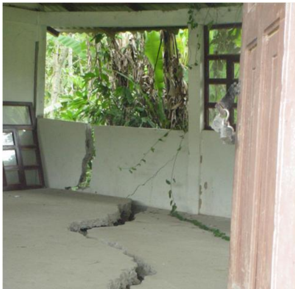
Fotografía 49: Fisuras de las paredes y pisos sector Santa Cecilia
