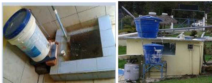
Figuras 20 y 21: Cámara de Cloración
