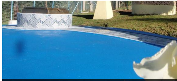
Figura 22: Tanque de Almacenamiento
