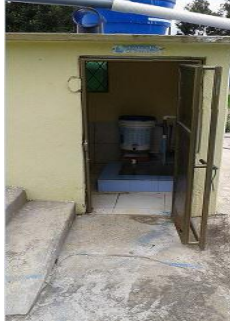
Figura 10: Cámara de cloración
