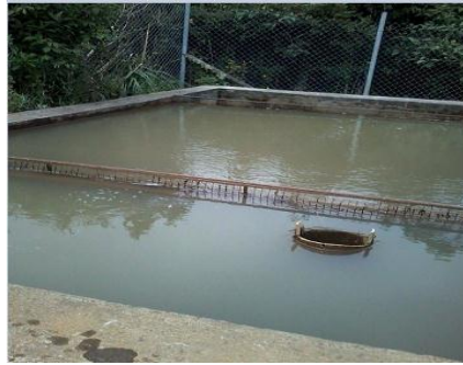
Figura 5: Captación 3 (Santa Ana)
