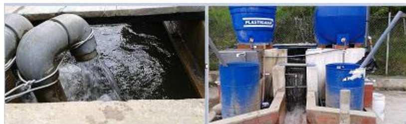
Figuras 12 y 13: Ingreso del agua cruda en la planta de tratamiento de Bayas
