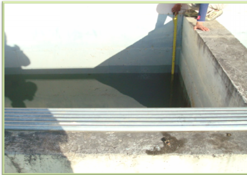
Fig. 35a. Determinación de la velocidad de filtración
