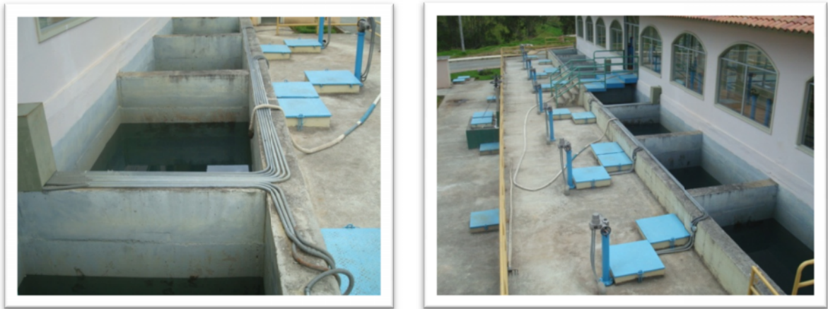
Fig. 8 Batería de filtros
