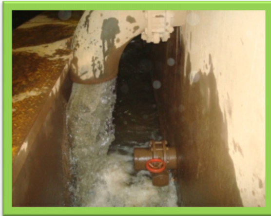
Fig. 22a. Canal de desagüe de retrolavado
