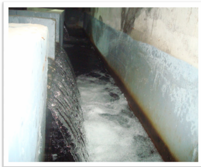
Fig. 33 vertederos individuales que comunica con el canal de interconexión.
