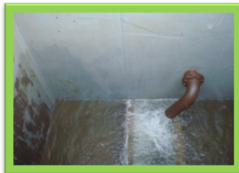
Fig. 21 Tubería que ingresa agua al filtro
