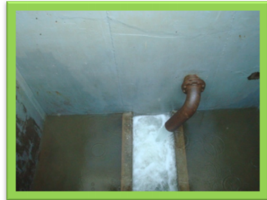
Fig.27b Tubería que ingresa agua al filtro
