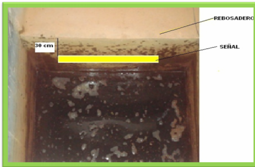
Fig. 28. Señal que indica el lavado de un filtro
