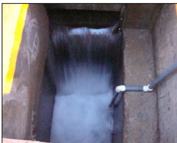
Fig. 9. Punto de inyección de cloro en la cámara de contacto
