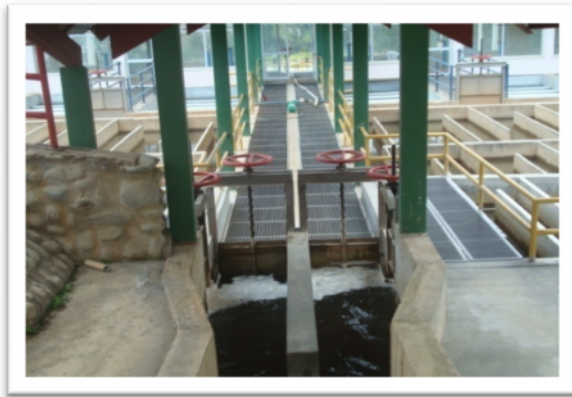
Fig. 6a Compuerta que regula el ingreso de agua a los floculadores
