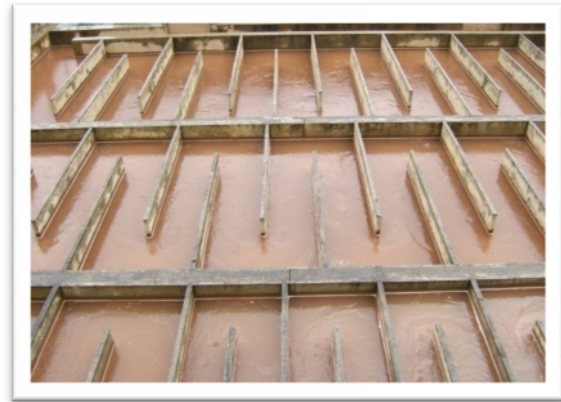
Fig. 6b Floculador hidráulico de flujo horizontal
