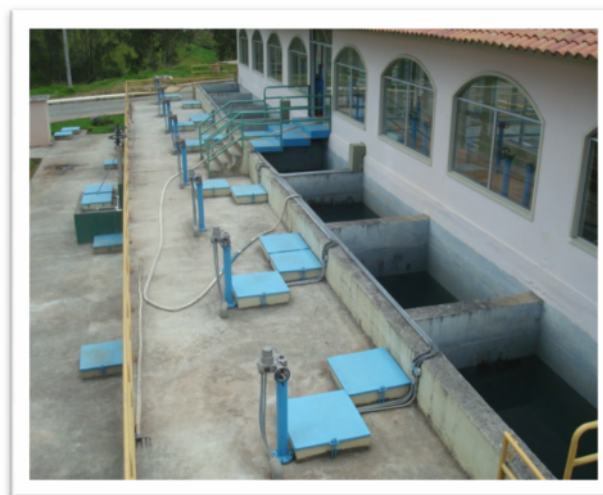
Fig. 32. Baterías de filtros de la PTM
