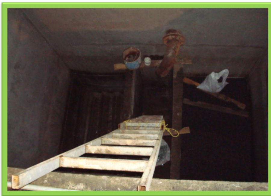
Fig. 20a. Caja de filtro cuando se cambió el lecho filtrante
