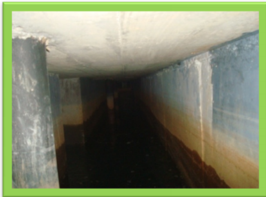
Fig.27a Canal común de agua sedimentada
