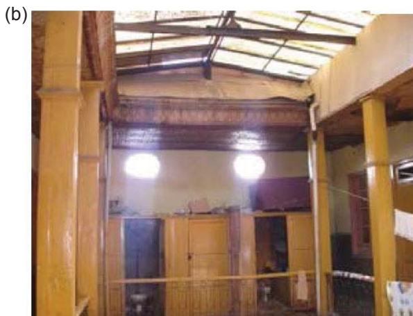
Fig. 124. Creación de bodega en planta baja (a) como consecuencia de cierre del fondo del corredor principal. Servicios higiénicos en planta alta (b) como consecuencia de cierre de pared de fondo.
