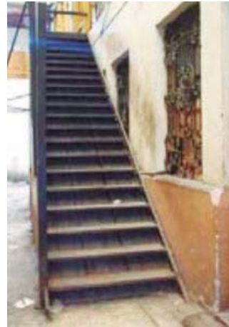
Fig. 126. Grada metálica al fondo en ala oeste (a). Acercamiento de grada metálica en ala oeste (b). Año 2005
