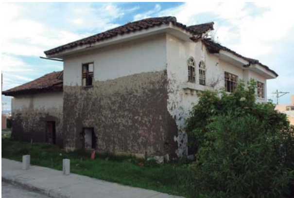
Fig. 93. Fotografía de elevación norte en el que se observa el desgaste del revoque sobre el muro de adobe.
