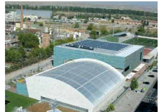
Foto 3.22. Cubierta con paneles solares en Pabellón polideportivo.
