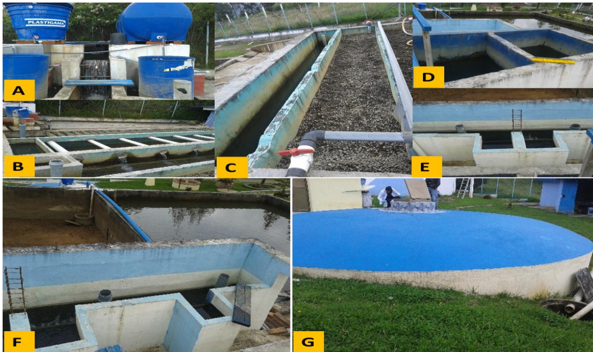
Figura 16. Planta de tratamiento. A: agua de entrada 1, B: floculadores y sedimentadores, C: pre-filtros, D: filtros rápidos, E: salida de los filtros, F: piscinas de filtración lenta y G: tanque de almacenamiento.
