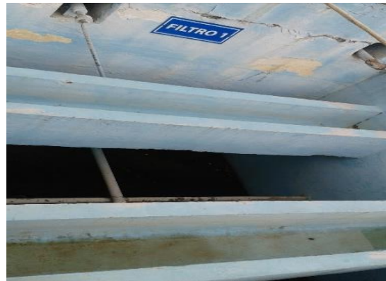
Imagen 7: filtro de arena
