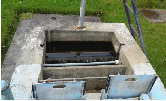
Imagen 4: entrada del agua cruda
