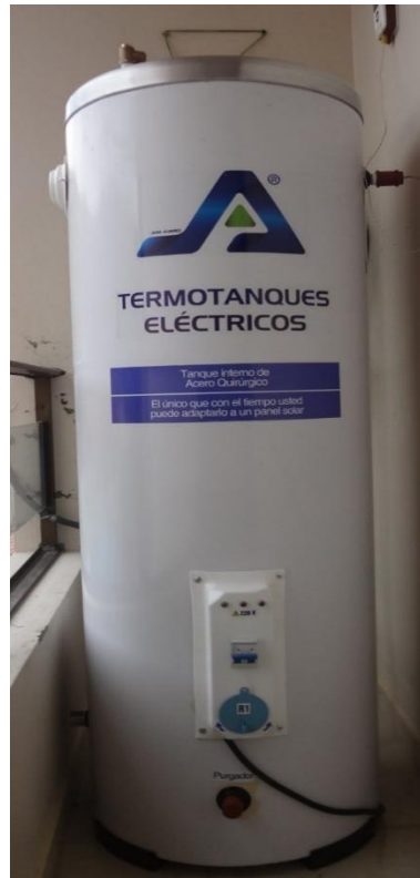
Figura 3.14 Fotografía de la instalación del termotanque eléctrico y los equipos de medición
