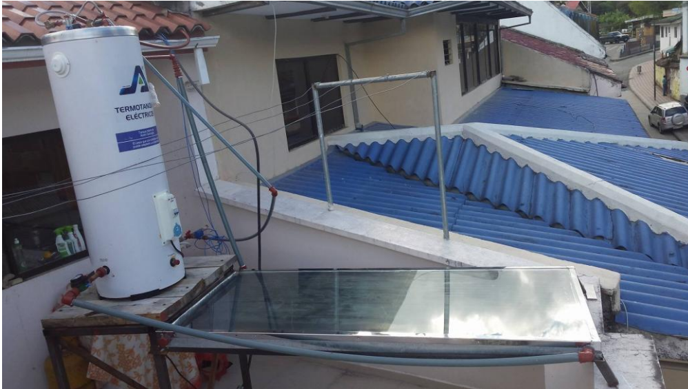
Figura 3.16 Fotografía de la instalación del sistema solar - eléctrico y los equipos de medición
