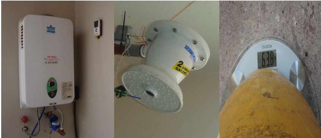
Figura 3.8 Fotografía de la instalación del calefón a GLP y los equipos de medición
