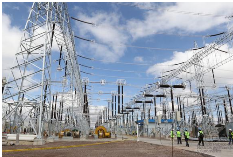
Figura 1.4 Subestación eléctrica de 500kV El Inga, para procesar la energía eléctrica generada por las centrales Coca Codo Sinclair y Sopladora.
