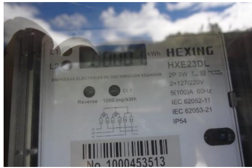
Figura 3.22 Fotografía del registro de consumo de energía eléctrica
