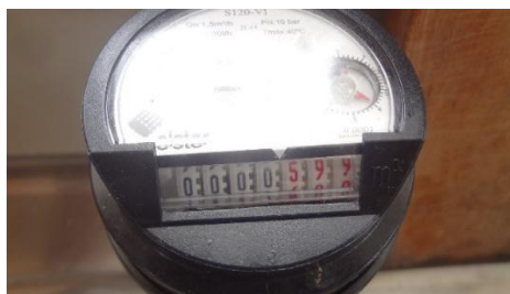
Figura 3.20 Fotografía del registro de consumo de agua caliente en el lavavajillas
