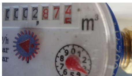
Figura 3.18 Fotografía del registro de consumo del total de agua caliente en el departamento
