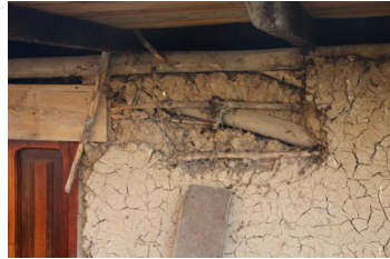
Fotografía 76: Puente térmico. Fuente: Grupo de tesis, 2016.
