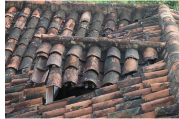
Fotografía 77: Infiltración de aire. Fuente: Grupo de tesis, 2016.
