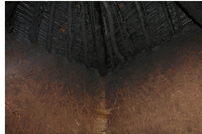
Fotografía 32. Paredes. Fuente: Grupo de tesis, 2016.
