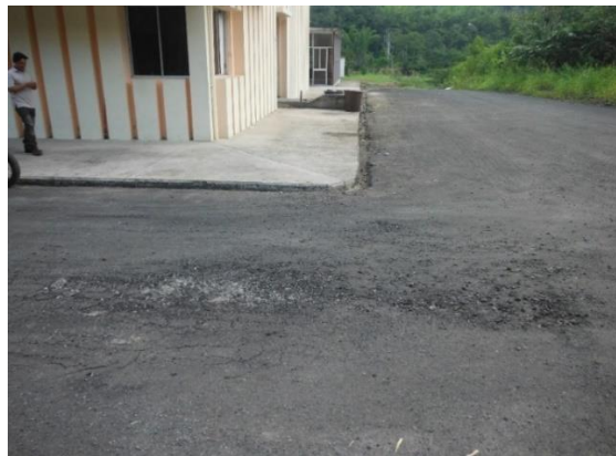
Fotografía 3.17 Pérdida de áridos vía acceso al camal de Méndez.
