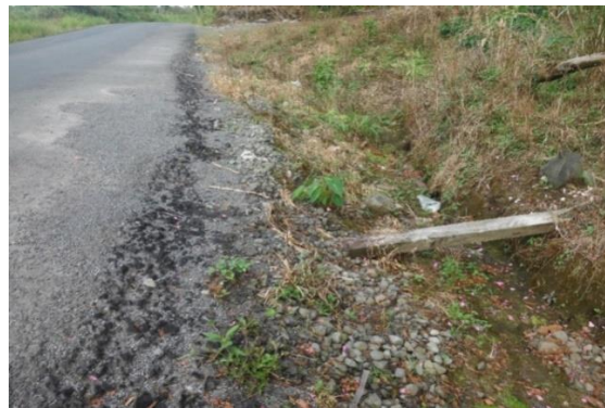
Fotografía 3.19 Estado de drenaje vía Troncal Amazónica - Mutinsa.
