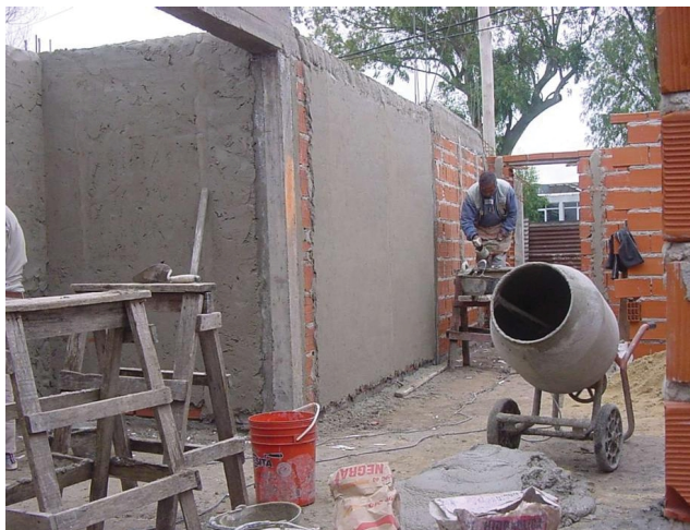
Imagen 08 Desperdicios y suciedad de un sistema constructivo húmedo
