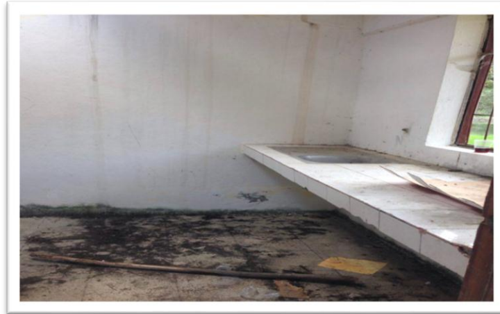
Imagen No 33: Laboratorio y área administrativa totalmente deteriorado y en desuso
