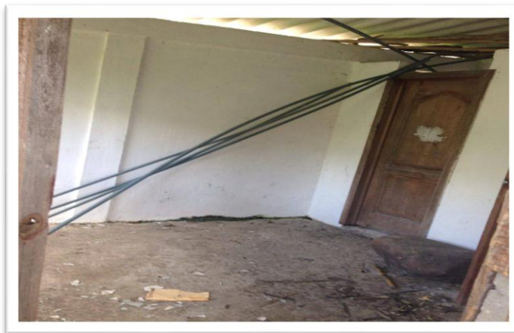
Imagen No 34: Baños y sala de estar en condiciones precarias
