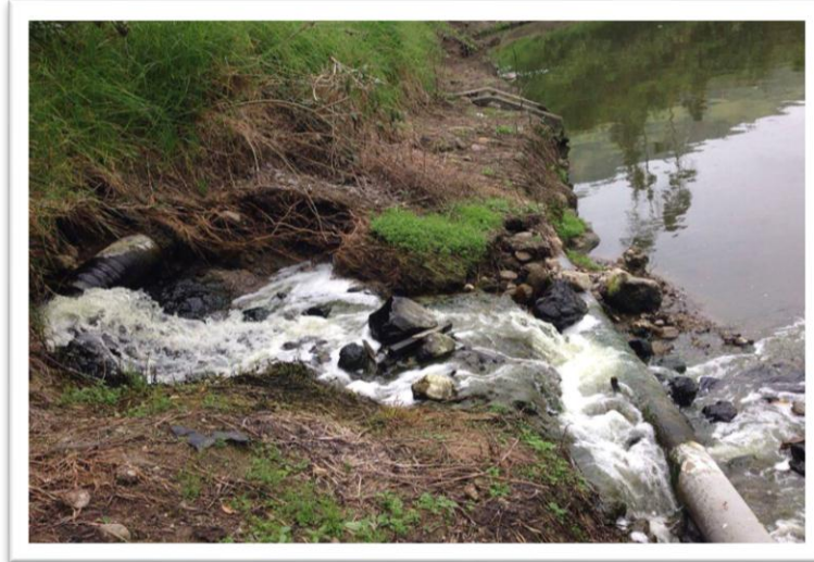
Imagen No 31: Tubería que conduce el agua residual a la Laguna de maduración rota
