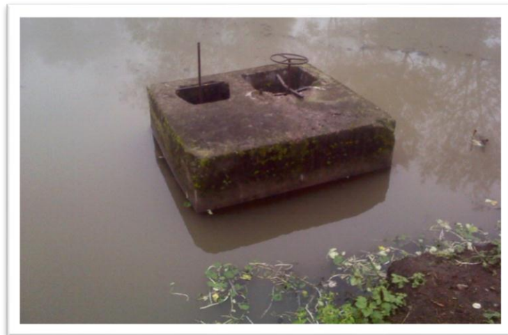
Imagen No 28: Compuertas de descarga
