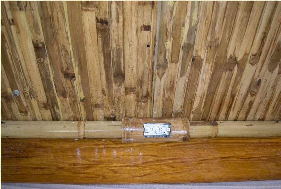
Figura: 76.- Imagen: Instalaciones eléctricas II.
