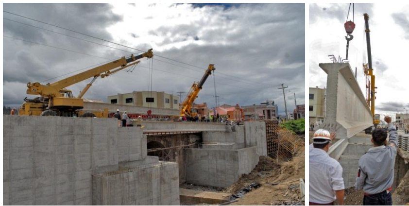
Foto 46 Montaje de vigas I en el puente la calera, se utilizan dos grúas hidráulicas para un mejor manejo del elemento. Se aprecia también el trabajo coordinado del personal al momento del montaje para un correcto alineamiento Fuente: C-RFV construcciones
