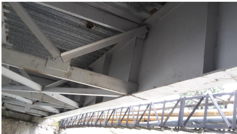
Foto 78 Rigidizadores en vigas, riostras entre vigas
