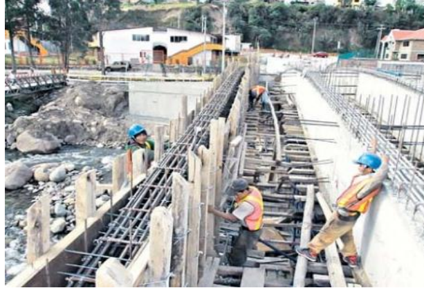
Foto 21 Acero de refuerzo usado en puente de hormigón armado Misicata Fuente: www.mercurio.com.ec
