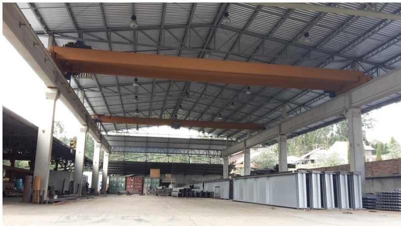
Foto 60 Puente grúa con tecla de 10 toneladas para manipulación interna de elementos. Talleres Arq. Patricio Aguirre
