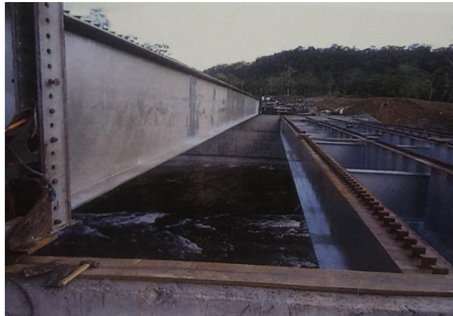
Foto 70 Deslizamiento del segundo tramo hasta su posición correspondiente Fuente: Arq. Patricio Aguirre
