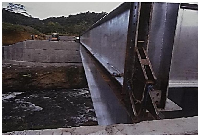
Foto 69 Lanzamiento del segundo tramo sobre el primer tramo colocado Fuente: Arq. Patricio Aguirre
