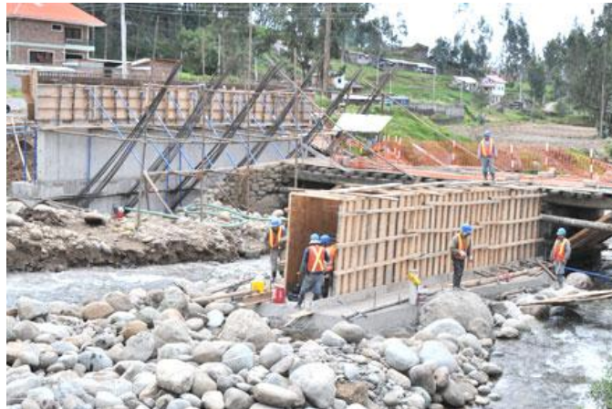
Foto 23 Encofrados de madera del puente sobre el río Yanuncay, construcción hormigón armado. Fuente: www.mercurio.com.ec
