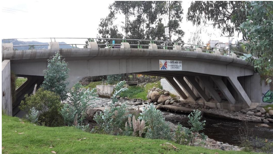
Foto 16 Puente tipo pórtico en Misticata 30 m de longitud y 14 de ancho Consorcio Vásquez Andrade.
