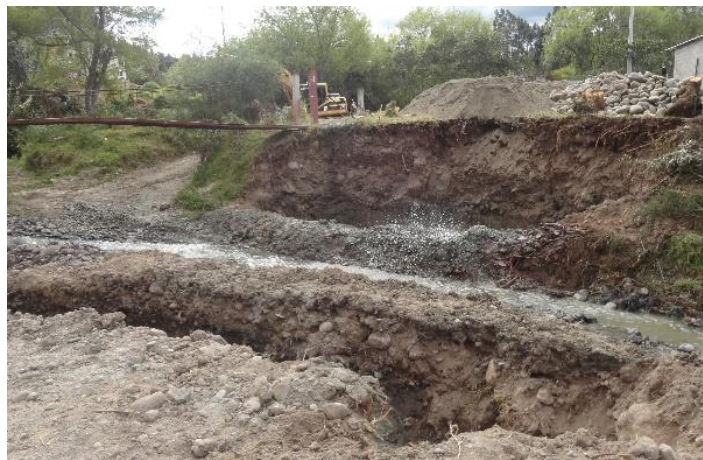
Foto 9 Puente sobre el río Sidcay Excavación de cimientos para zanjas, muro y estribos
