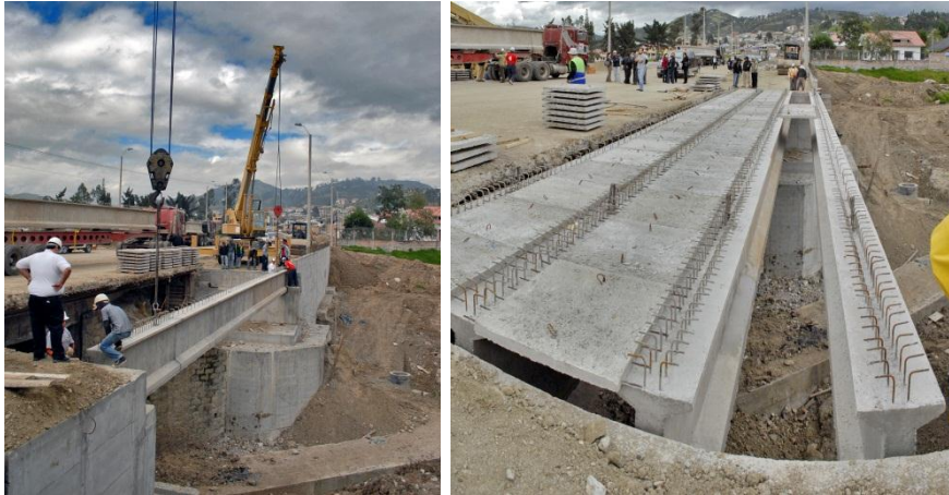
Foto 49 Ampliación del puente La Calera para el proyecto tranvía Fuente: C-RFV construcciones
