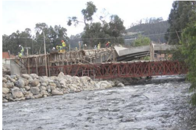
Foto 24 Cercha metálica para encofrado de losas. Puente sobre el río Yanuncay Fuente: www.mercurio.com.ec
