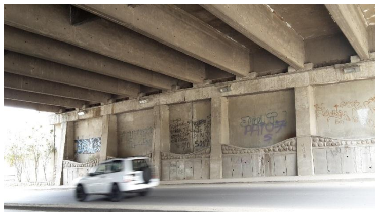
Foto 13 Puente, hormigón armado de vigas rectas simplemente apoyadas en los estribos, luz 20 m y 15 m de ancho.
