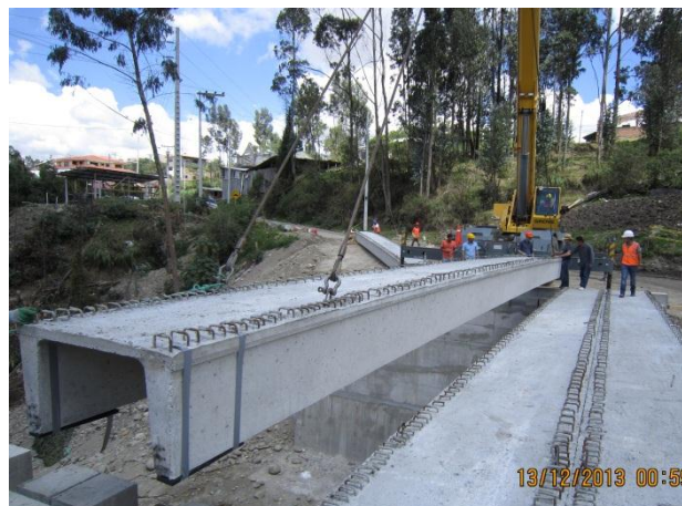
Foto 48 Puente de Acceso al centro de Rehabilitación Social de Turi. Montaje de sus elementos Fuente: C-RFV construcciones
