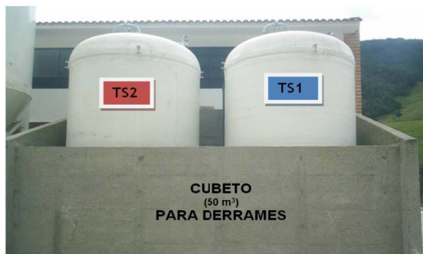
Gráfico 4-25. Tanques de almacenamiento de sulfato de aluminio.
