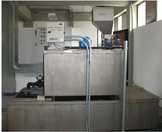
Fig. 1-33. Sistema de dosificación del polielectrolíto para floculación del fango.
