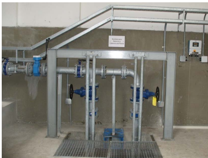
Fig. 1-31. Depósito de Recuperación de agua de lavado de filtros
