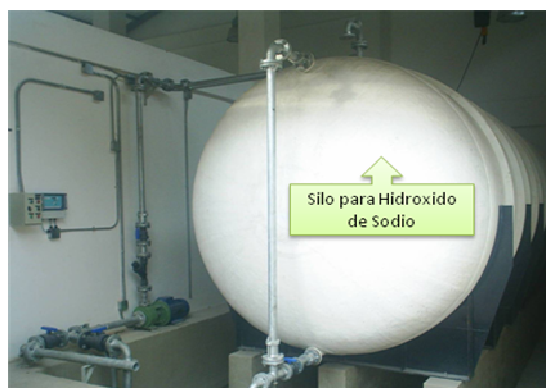
Gráfico 4-30. Silo de Almacenamiento de hidróxido de Sodio.
