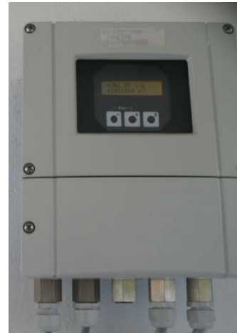
Fig. 1-6. Display del medidor de caudal en el ingreso de agua cruda
