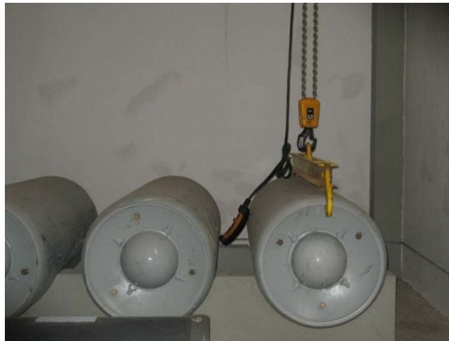
Fig.1- 28. Tanques de Almacenamiento de Cloro FUENTE: AUTOR
