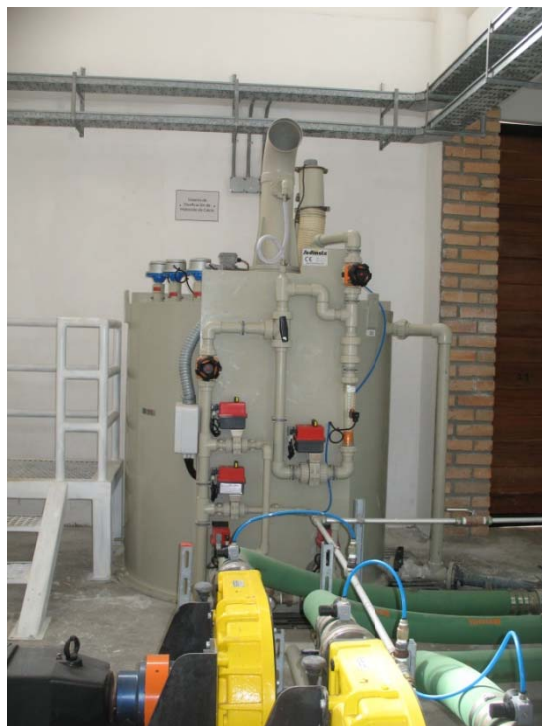
Gráfico 4-31. Cuba de preparación de lechada de cal.
