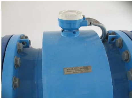
Fig. 1-5 Medidor de caudal en el ingreso de agua cruda
