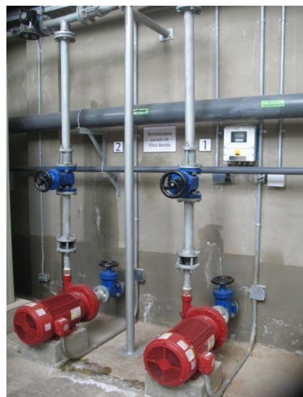
Fig. 1-37. Bombas para lavado de Filtro Banda
