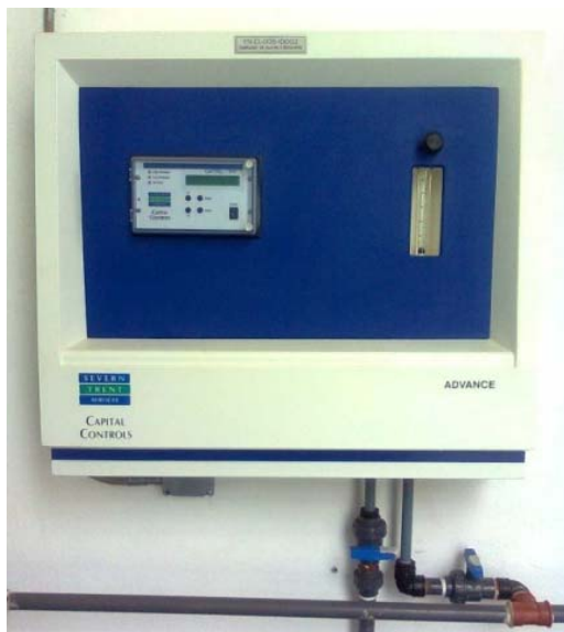
Fig. 1-29. Dosificador de Cloro (Rotámetro)
