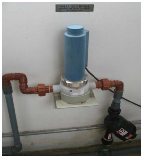
Fig. 1-9. Medidor de pH en el ingreso de agua cruda
