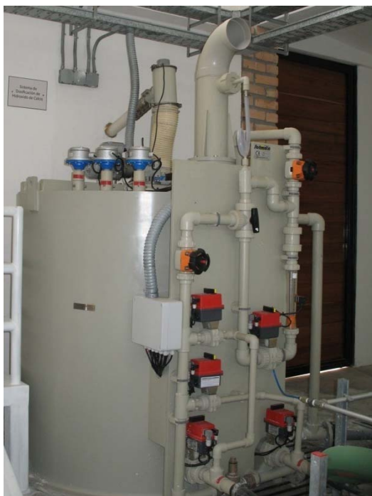
Fig. 1-19. Sistema de dosificación de Hidróxido de Calcio
