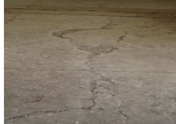
Figura 3.53. Fisuras y huecos en el suelo.
