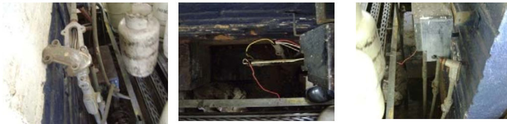
Figuras 3.3, 3.4 y 3.5. Riesgo Eléctrico.
