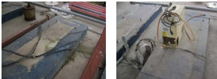
Figuras 3.1 y 3.2. Cuarto de bombas y compresores.
