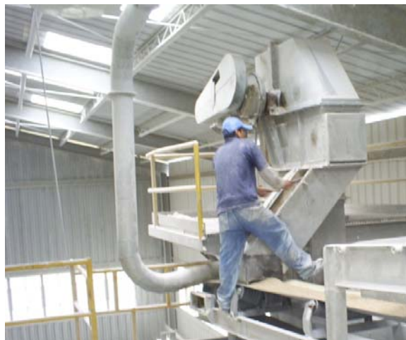
Foto N°2 Descarga del Elevador EA, Planta de Molienda de Italpisos Fuente: Los Autores
