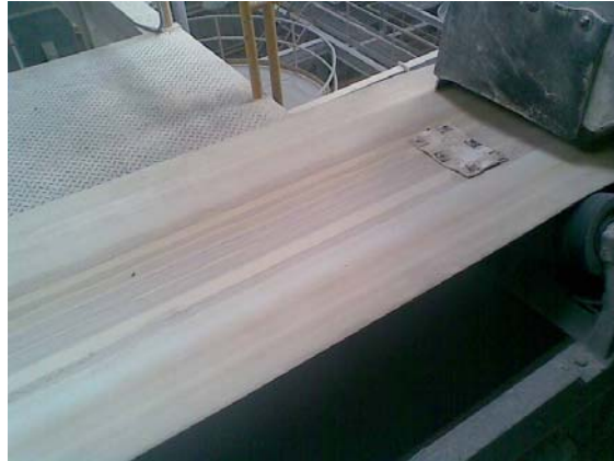
Foto N°18 Banda b2 con parchamiento, Planta de Molienda de Itaipos Fuente: Los Autores
