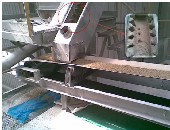
Foto N°16 Material retenido-Boca de descarga Elevador EA, Planta de Molienda de Itaipos
