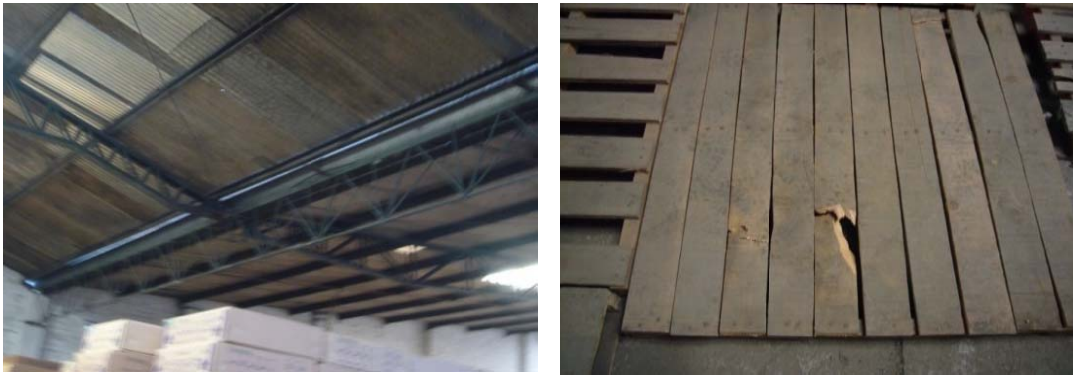
FIG.N° 6: Fotografías del techo y pallets de la bodega de producto terminado, ubicadas en Quinta Chica
