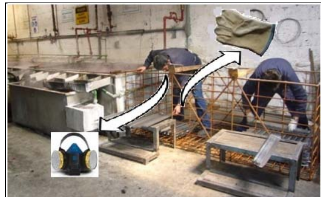
FIG N° 15: Falta del EPP
