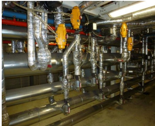
Figura 59. Aislamiento de tuberías en zanjas Fuente: Autor
