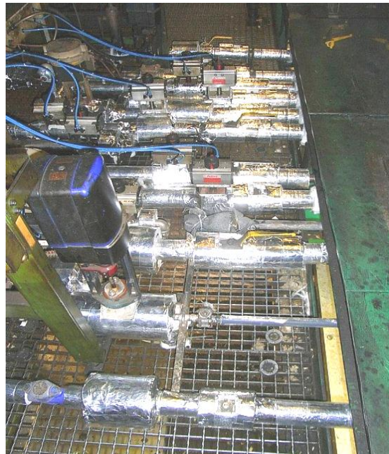
Figura 54. Aislamiento de tuberías de vapor
