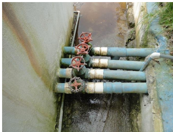
Figura 1-4. Válvulas de los efluentes FUENTE: AUTOR
