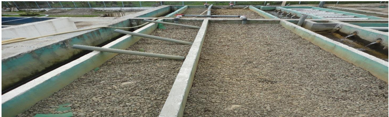
Figura 1-10. Pre filtros FUENTE: AUTOR
