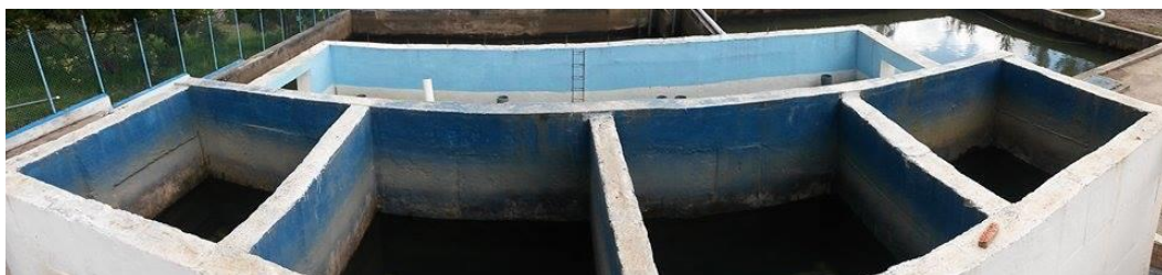
Figura 5-1. Batería de filtros de tasa declinante y lavado mutuo FUENTE: Autor
