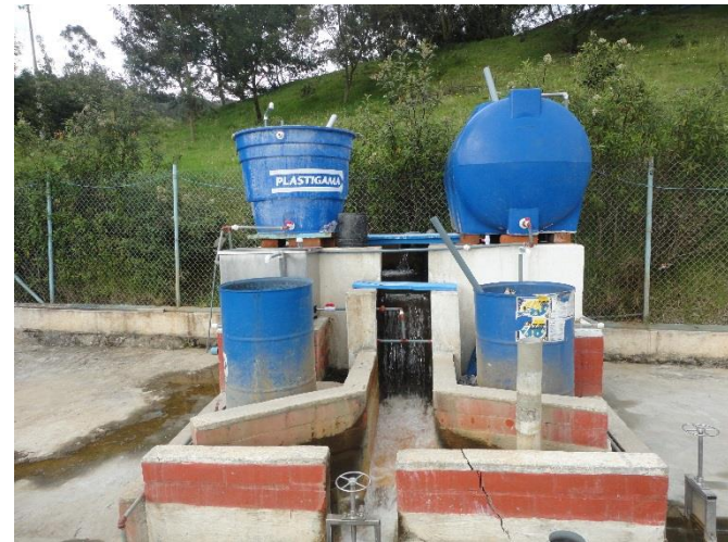
Figura 1-6. Tanques de Sulfato FUENTE: AUTOR
