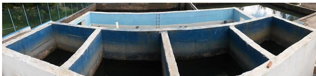
Figura 1-11. Batería de 4 filtros FUENTE: AUTOR
